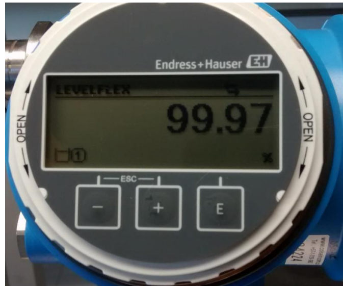
FIGURA 4-11: LECTURA DEL SENSOR LEVELFLEX-FMP52 TK-20 LLENO. FUENTE: AUTOR
