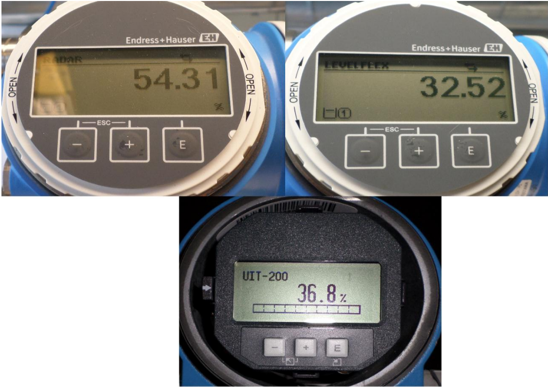
FIGURA 4-12: LECTURA EN PANTALLA DE LOS SENSORES EN LOS TANQUES TK-10A Y TK20 SIN TURBULENCIA. FUENTE: AUTOR
