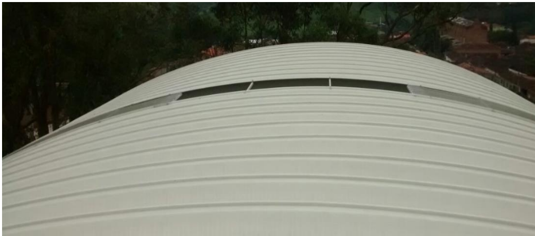
Ilustración 30. Daños de la cubierta. Fuente: ARQUIACERO S.A.S.
