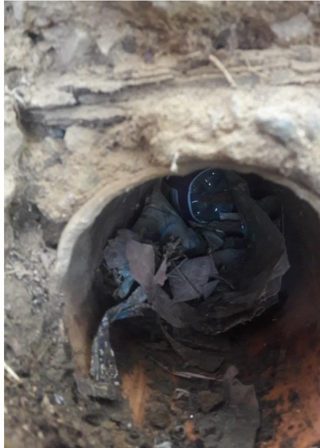
Ilustración 21. Residuos sólidos dentro de la tubería. Fuente: Propia.
