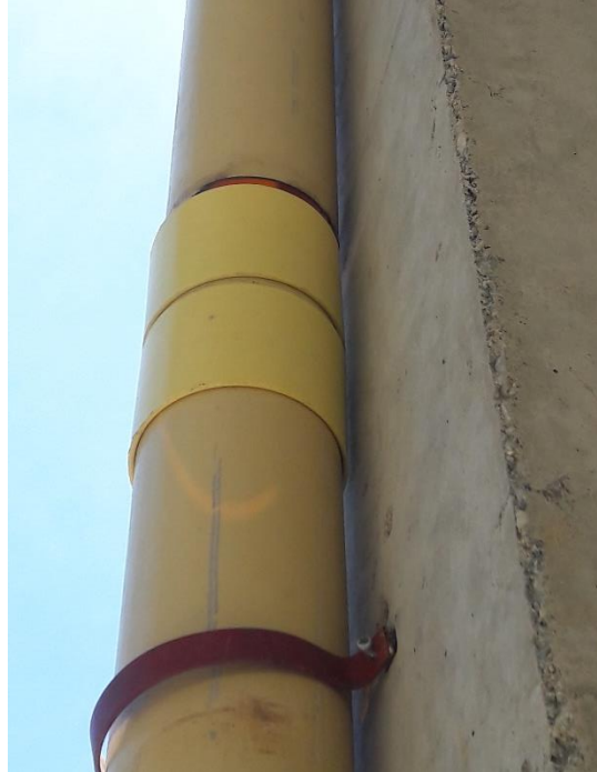
Ilustración 17. Unión despegada. Fuente: Propia.
