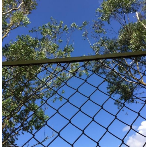
Ilustración 36. Algunos daños que se presentaron en el cerramiento. Fuente: Secretaria de planeación Municipal (Valle de San José).
