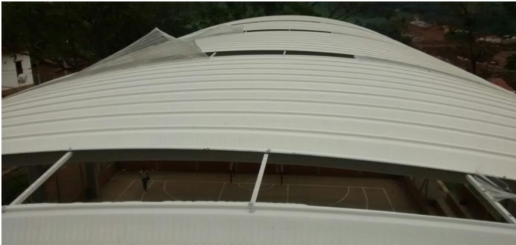
Ilustración 29. Daños de la cubierta. Fuente: ARQUIACERO S.A.S.
