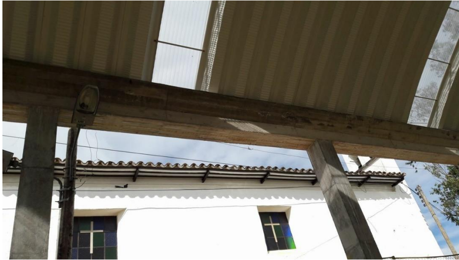
Ilustración 15. Registro fotográfico de las eflorescencias en las vigas canal. Fuente: Propia.
