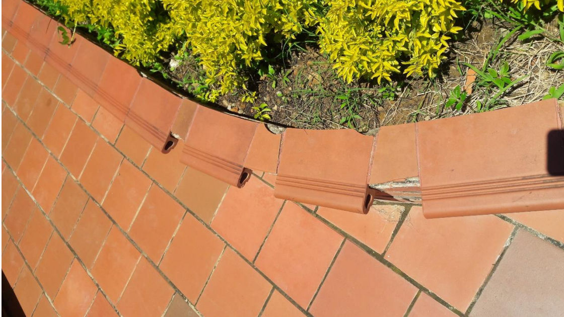
Ilustración 25. Daños en la cerámica del Hospital Municipal. Fuente: Propia.
