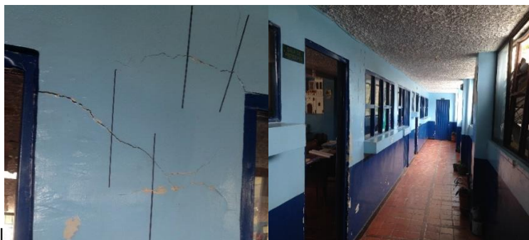
Ilustración 6, Agrietamiento, Colegio San Juan Nepomuceno, Vetas, Santander
