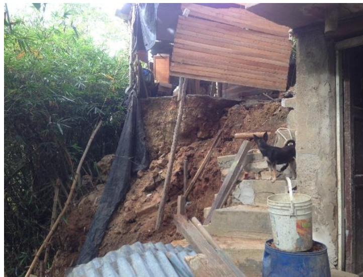
Ilustración 11, Vista trasera de la casa, habitación afectada.
