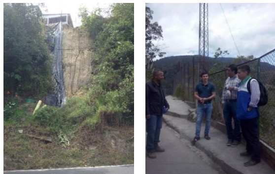
Ilustración 5, Talud Escuela en Toná, vía a Cúcuta
