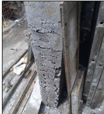
Ilustración 16. Segregación de concreto post fundida cuchillas torre 3
