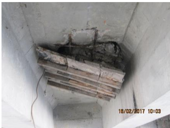
Imagen 2 Bache sobre la calzada puente Aguaclara Tramo 8
