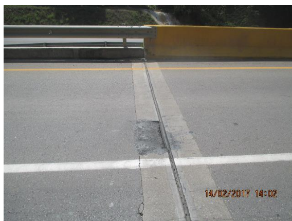
Imagen 5 panorámica juntas en mal estado, puente el ható tramo 5
