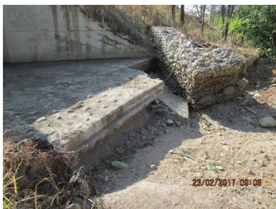
Imagen 7 socavación por inestabilidad de terreno Fuente: Autor del proyecto
