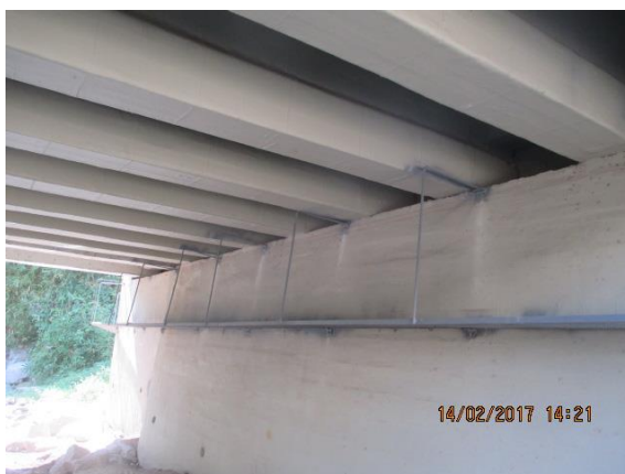
Imagen 3 Falta de neoprenos, Puente guaduas tramo 8
