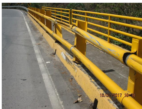
Imagen 6 Panorámica Barandas en mal estado, puente múcura (tramo 8)
