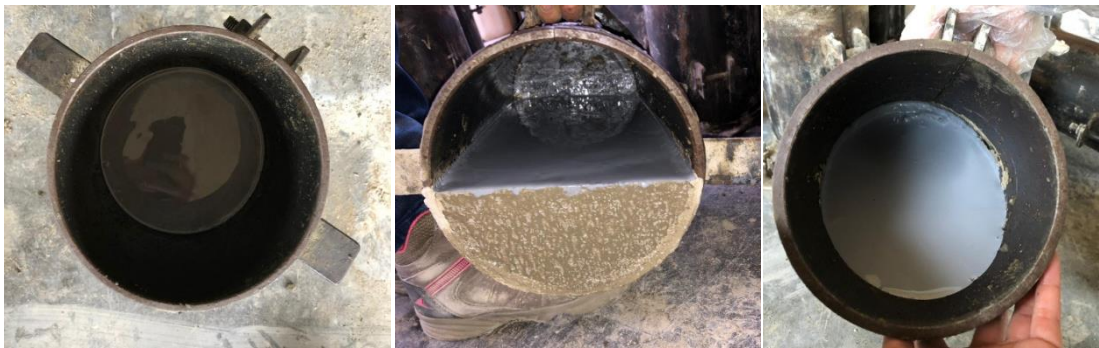
Figura 16. Aplicación de Epotoc 1-1 juntas horizontal, vertical, diagonal. Fuente: Propia. Universidad pontificia Bolivariana.
