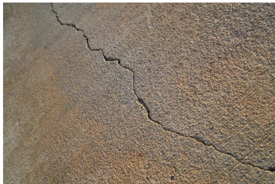
Figura 4. Agrietamiento de superficies. Fuente: 360 Concretos-Argos Colombia[22].
