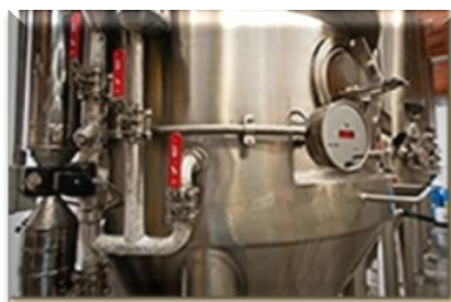
Figura 31. Control tanque de maduración
