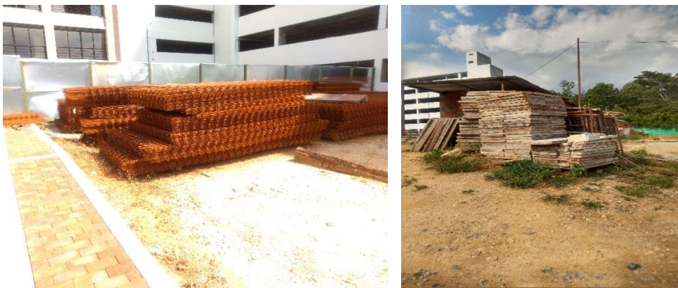
FIGURA 50. ESTADO DE MATERIALES EN OBRA.
