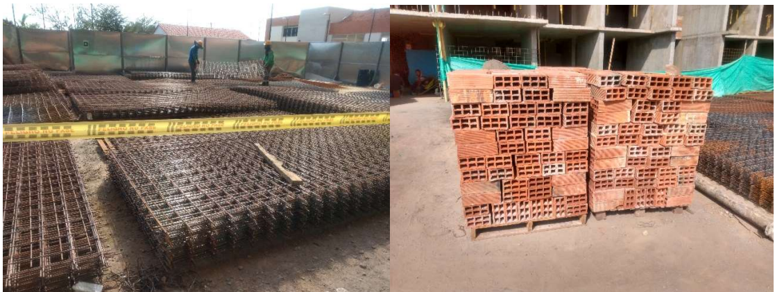
FIGURA 45. ESTADO DE MATERIALES EN OBRA.
