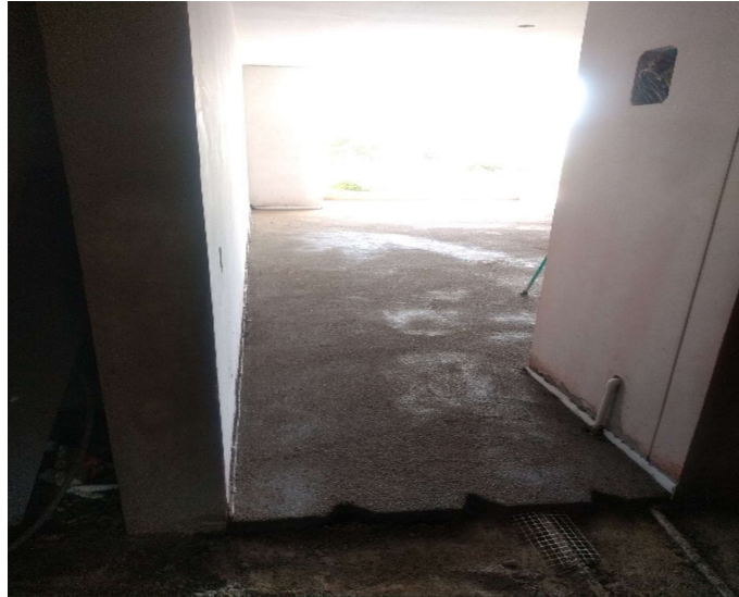
FIGURA 24. MALLA SIN VENA EN TUBERÍA DE GAS
