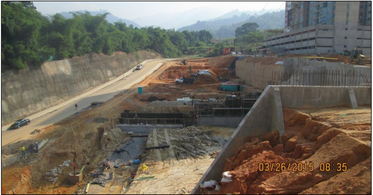
Figura 28. Construcción del muro escalera y adecuación de terrenos para el club social
