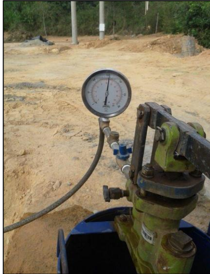
Figura 15. Bomba y manómetro
