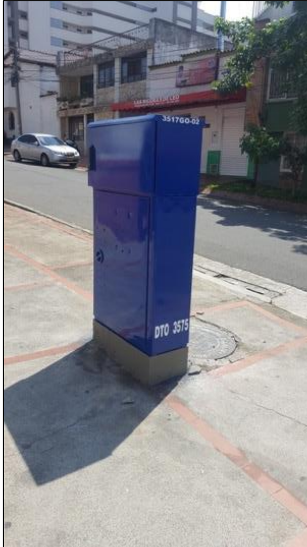
Figura 11 Gabinete óptico instalado sobre armario KRONNE – San Francisco Fuente: Autor
