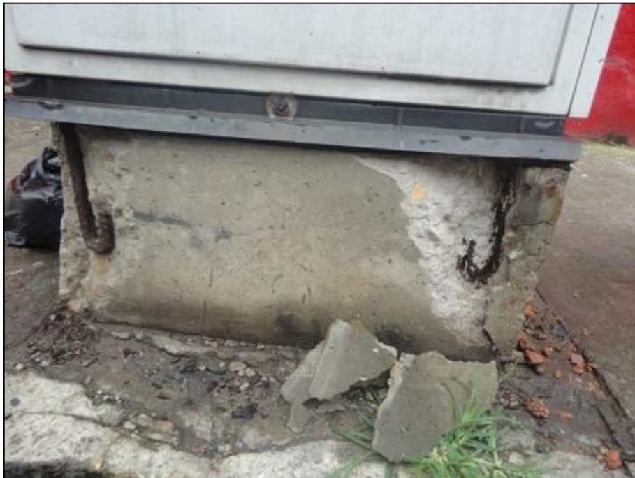
Figura 58 Base armario sector Girardot pendiente por intervenir Fuente: Autor
