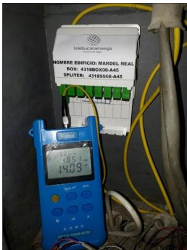
Figura 16 Riser box instalada en Mardel Real Fuente: TELEBUCARAMANGA S.A
