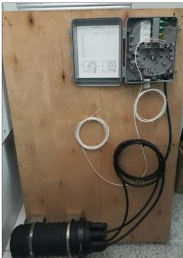
Figura 7 Elementos de infraestructura de la red FTTH (Domo, Nap indoor, Fibra) Fuente: Ingeniera Laura Pérez Cárdenas - Coordinación de proyectos Telebucaramanga S.A
