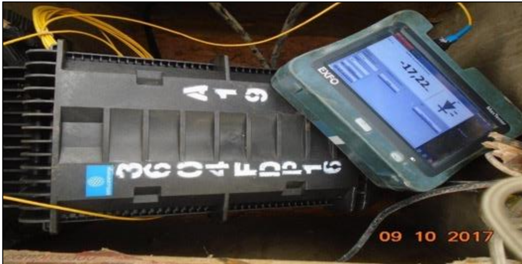
Figura 17 Nap outdoor de 16 puertos instalada en Cerros de cañaveral Fuente: TELEBUCARAMANSA S.A
