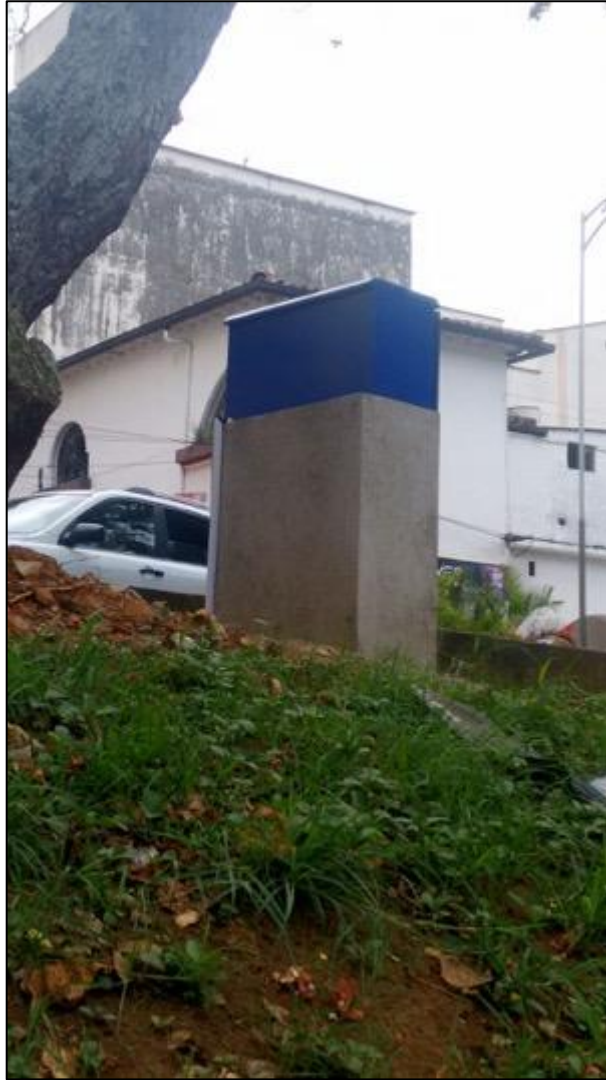
Figura 12 Gabinete óptico instalado sobre base en concreto – Parque Mejoras Públicas Fuente: Autor
