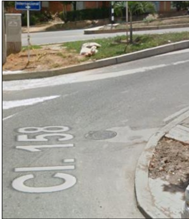
Figura 20 Cámara sobre vía pública
