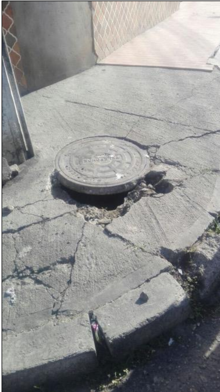
Figura 60 Cámara ubicada en sector San Rafael – Esquina calle 3 con carrera 11 Fuente: Autor
