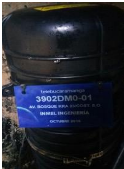
Figura 13 Domo de fibra óptica con su respectiva marquilla para fácil reconocimiento Fuente: TELEBUCARAMANGA S.A
