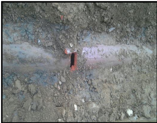
DICIEMBRE 11 DE 2015 - PARTE DE HALLAZGO TUBERÍA ALCANTARILLADO, CAUSANTE DE FALLO DE 15m.
