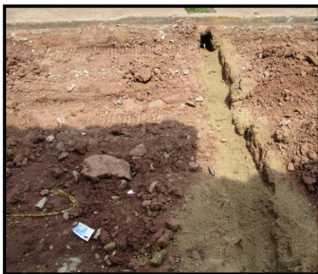
DICIEMBRE 12 DE 2015 - RELLENO DE ZANJAS DE HUNDIMIENTO DE TUBERÍAS EN CALLE 8, BARRIO ÁLAMOS.
