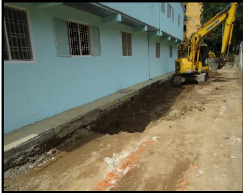
DICIEMBRE 11 DE 2015 - HALLAZGO DE FALLO EN CALLE 2 - BARRIO TURBAY.
