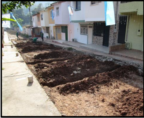
DICIEMBRE 07 DE 2015 HUNDIMIENTO TUBERÍAS DOMICILIARIAS EN LA CALLE 8 - B. ÁLAMOS.
