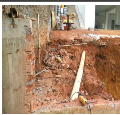
Foto 7: Tubo de aguas negras proveniente del predio del Sr. Jose
