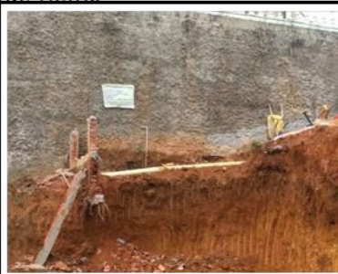
Foto 6: Tubo de aguas negras proveniente del predio del Sr. Jose Suarez. Vista frontal.
