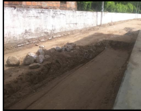
DICIEMBRE 11 DE 2015 - INTENTO DE COMPACTACIÓN DE MATERIAL, DONDE SE ENCONTRÓ FALLO.
