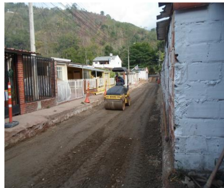
ENERO 8 DE 2016 - APLICACION Y COMPACTACION DE BASE GRANULAR SIN SEREO EN EXTREMO INFERIOR DE LA CALLE 8, BARRIO ALAMOS.
