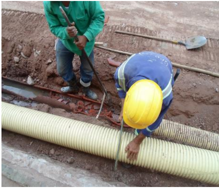
ENERO 8 DE 2016 - REPARACION DE TUBERIA DE ALCANTARILLADO PRINCIPAL DE LA CALLE 8, DEBIDO A FRACUTRAS ENCONTRADAS EN TUBERIA DE GRES EXISTENTE, SE REALIZÓ CAMBIO A TUBERIA PVC 8".
