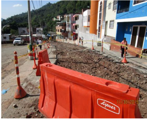
NOVIEMBRE 30 DE 2015 - CONTINUACIÓN DEMOLICIÓN DE PAVIMENTO CARRERA 9, BARRIO ALAMOS - K0+050 HASTA K0+070.
