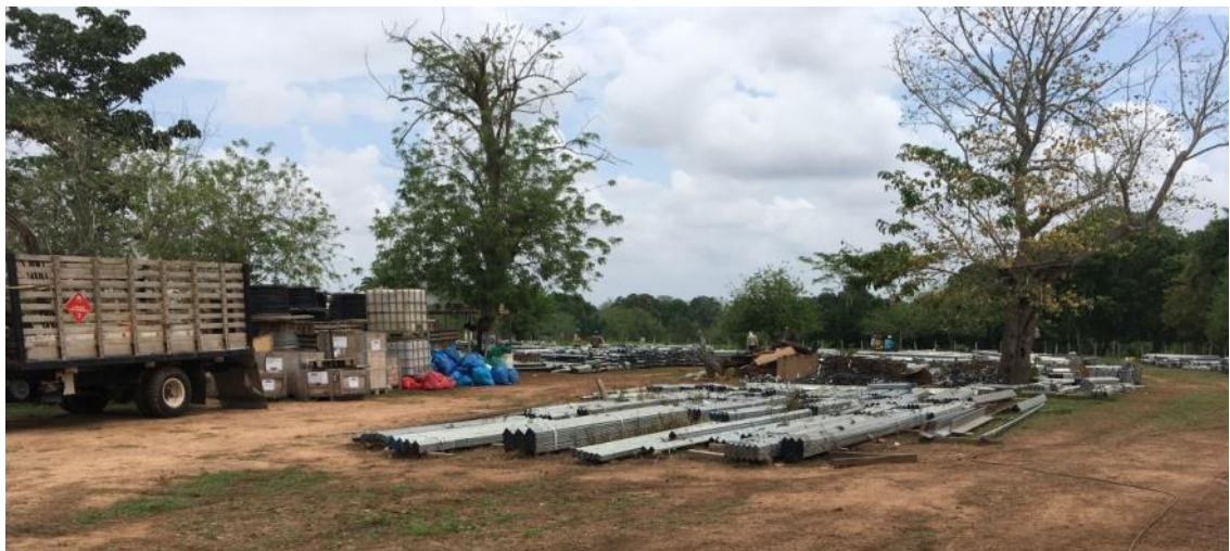
Ilustración 12: Almacén de materiales
