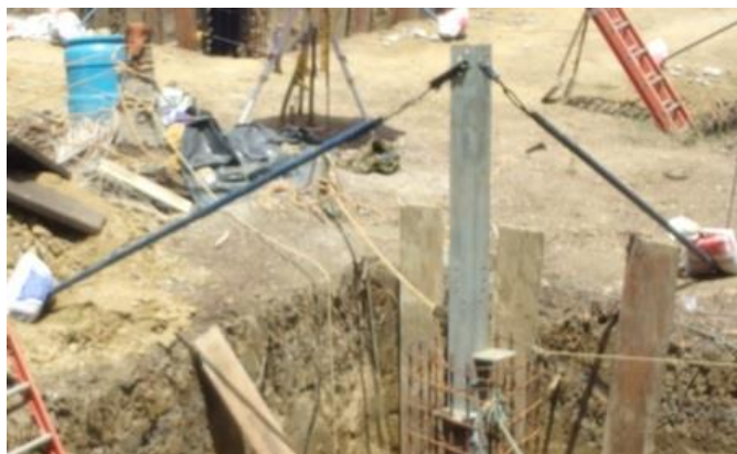
Ilustración 51: Stub armado y en sitio
