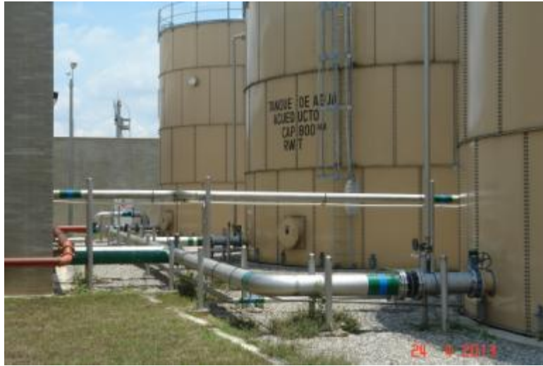
Figura 3. Tanque almacenamiento de agua.
