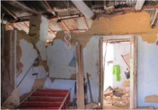
Figura 43. Vivienda afectada en Rionegro
