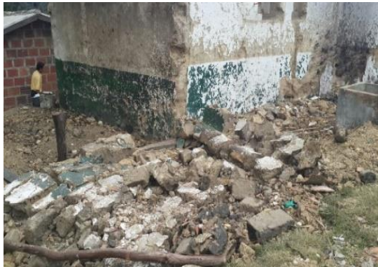
Figura 52. Vivienda Afectada en Onzaga
