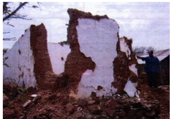
Figura 47. Vivienda afectada en Los Santos
