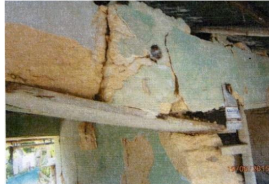
Figura 44. Vivienda afectada en Rionegro
