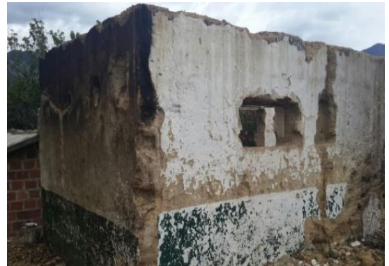
Figura 51. Vivienda afectada en Onzaga
