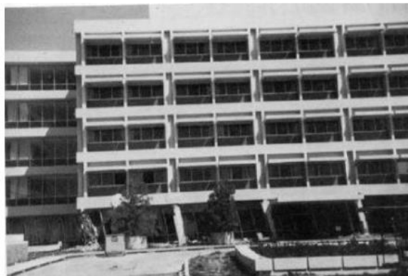
Figura 13. Daño general en columnas de primer nivel
