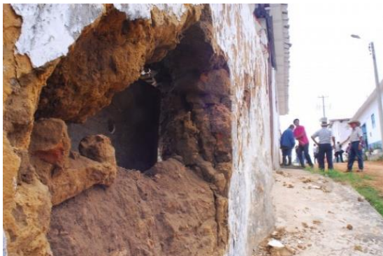
Figura 42. Vivienda afectada en Betulia
