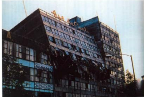
Figura 14. Falla debida al golpeteo entre edificios adyacentes que no coinciden con la altura de sus entresijos
