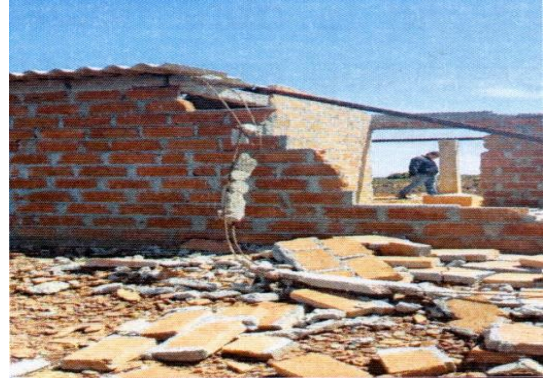
Figura 50. Vivienda afectada en Los Santos
