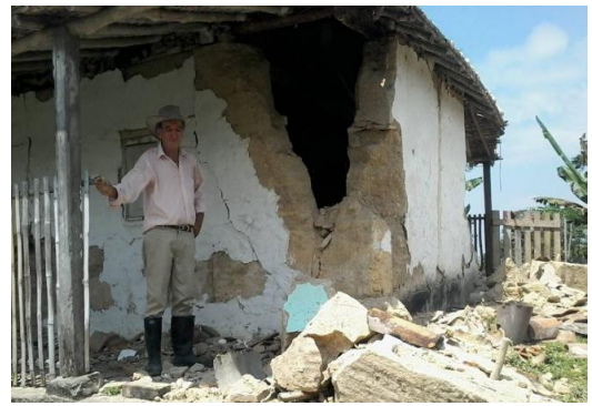
Figura 41. Vivienda afectada en Betulia
