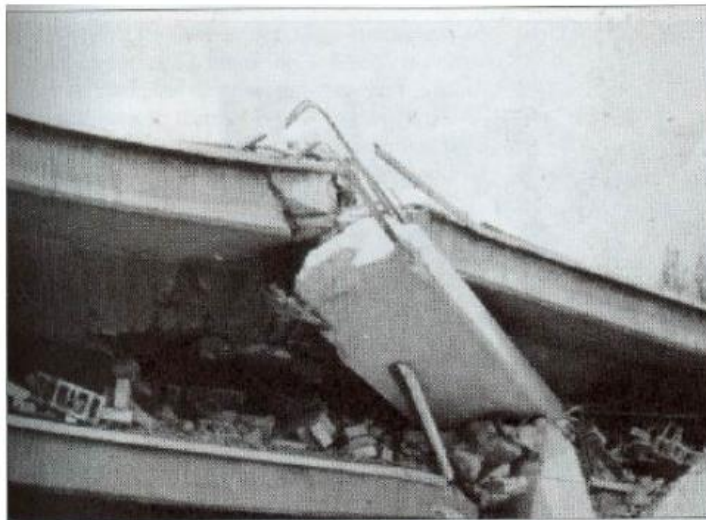
Figura 9. Falla en unión de viga-columna por escasez de anclaje en la conexión de la columna con el sistema de piso
