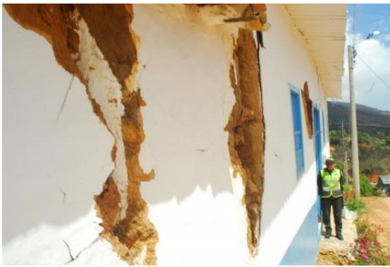
Figura 39. Vivienda afectada Betulia
