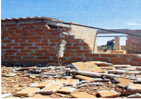
Figura 49. Vivienda afectada en Los Santos
