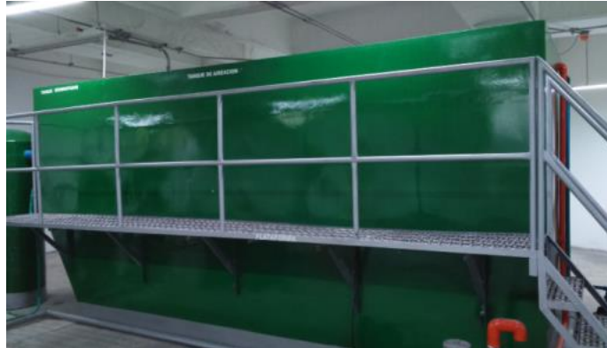
Figura 9. Tanque de aireación y Sedimentador de Alta Tasa
