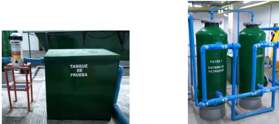
Figura 10. Clorinador y Sistema de Filtración, respectivamente
