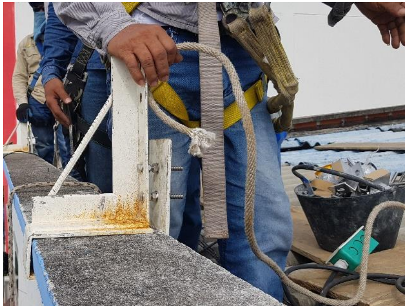
Imagen 7. Anclaje de la línea de vida
