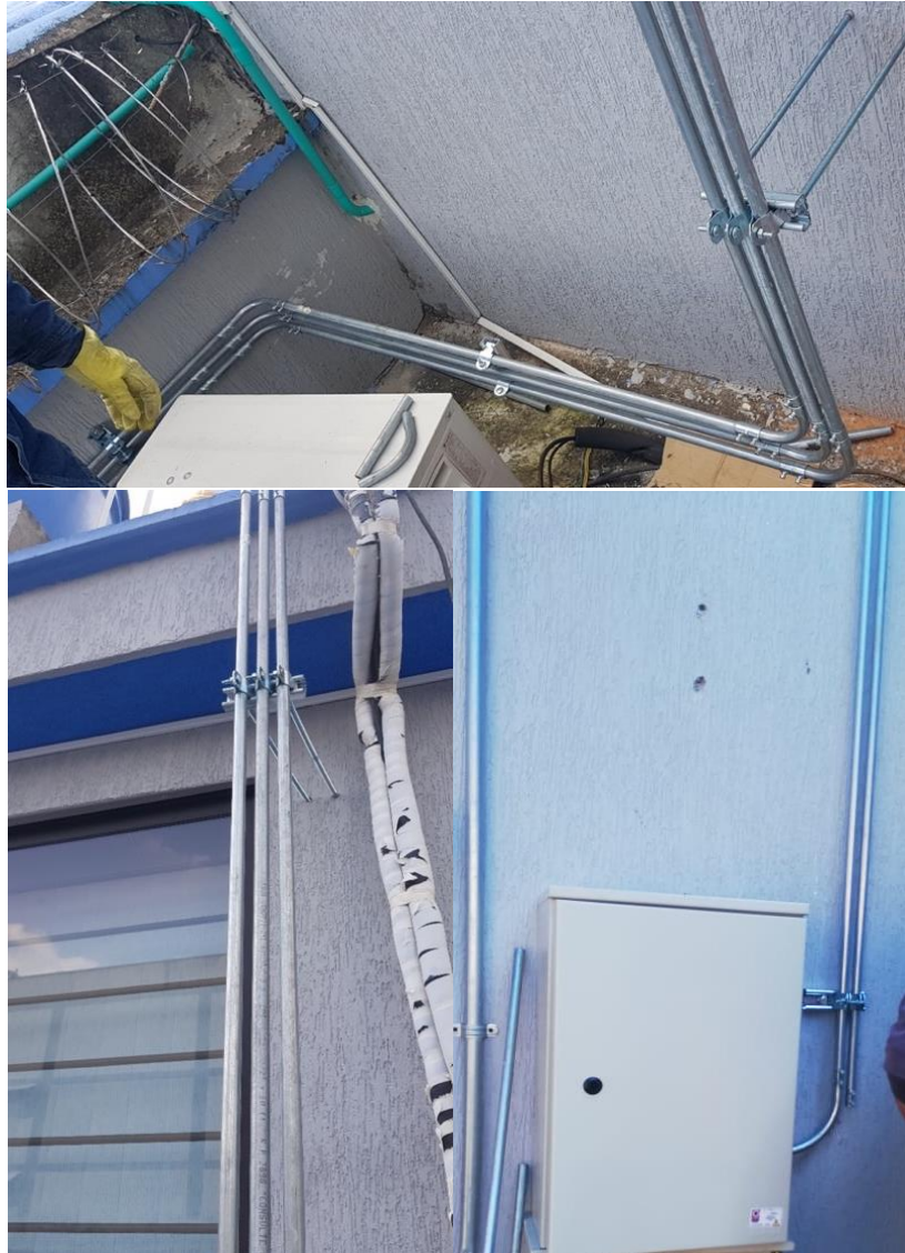
Imagen 16. Tubería de protección del cableado
