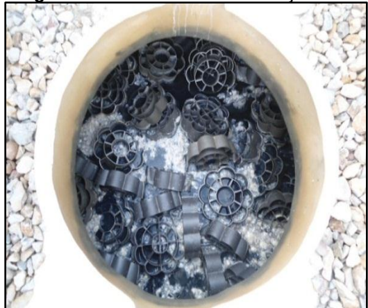
Imagen 18. Filtro Anaerobio de Flujo Ascen.
