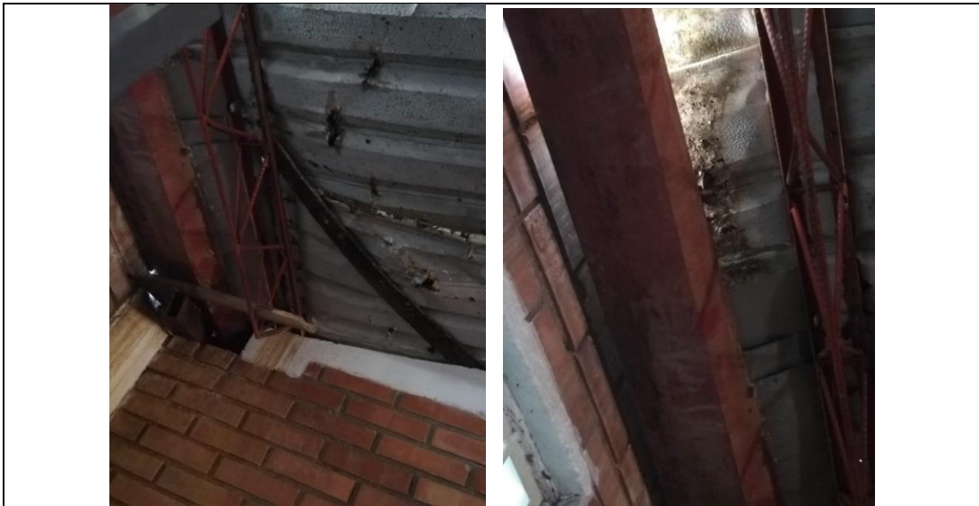
Imagen 7 – Canales de aguas lluvia – Se encuentran en total deterioro tanto en la fachada con en la parte interior.
