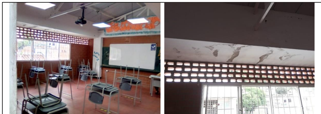
Imagen 6 – AULA 10 – Se aprecia desprendimiento de la pintura por la humedad.
