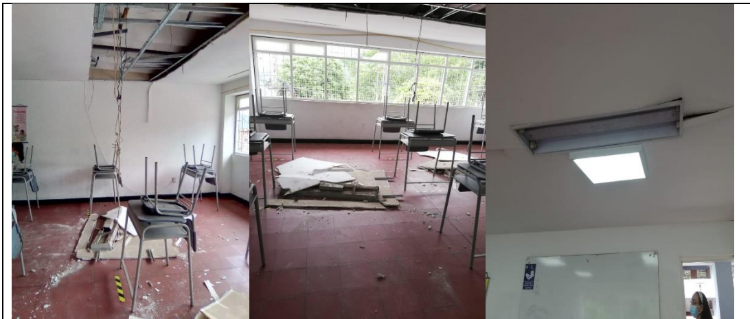
Imagen 6 – AULA 7 – En esta aula se evidencio la caída parcial de la estructura y láminas de cielo raso.
