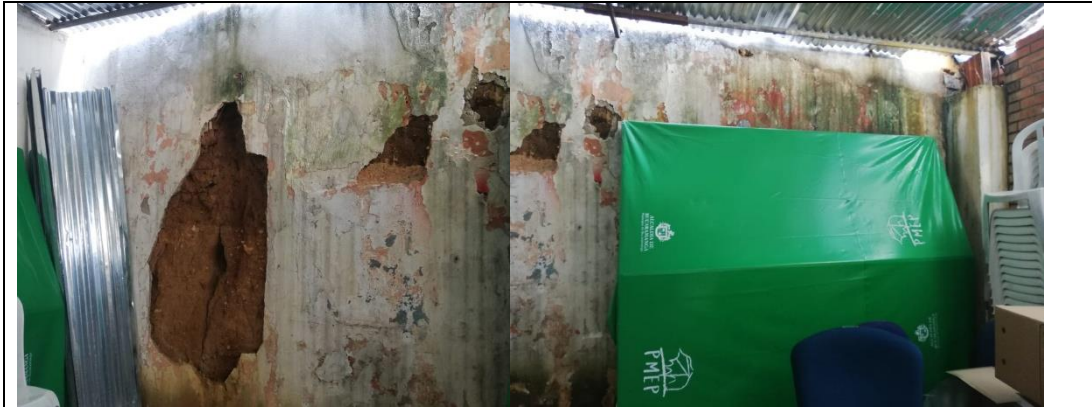
Imagen 7 – Taller de Reuniones – Total deterioro en el muro de cerramiento de medianía en el cual se puede apreciar que es en tapia pisada recubierta de pañete.
