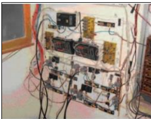
Figura 16. Controlador experto de sistemas fotovoltaicos autónomos
