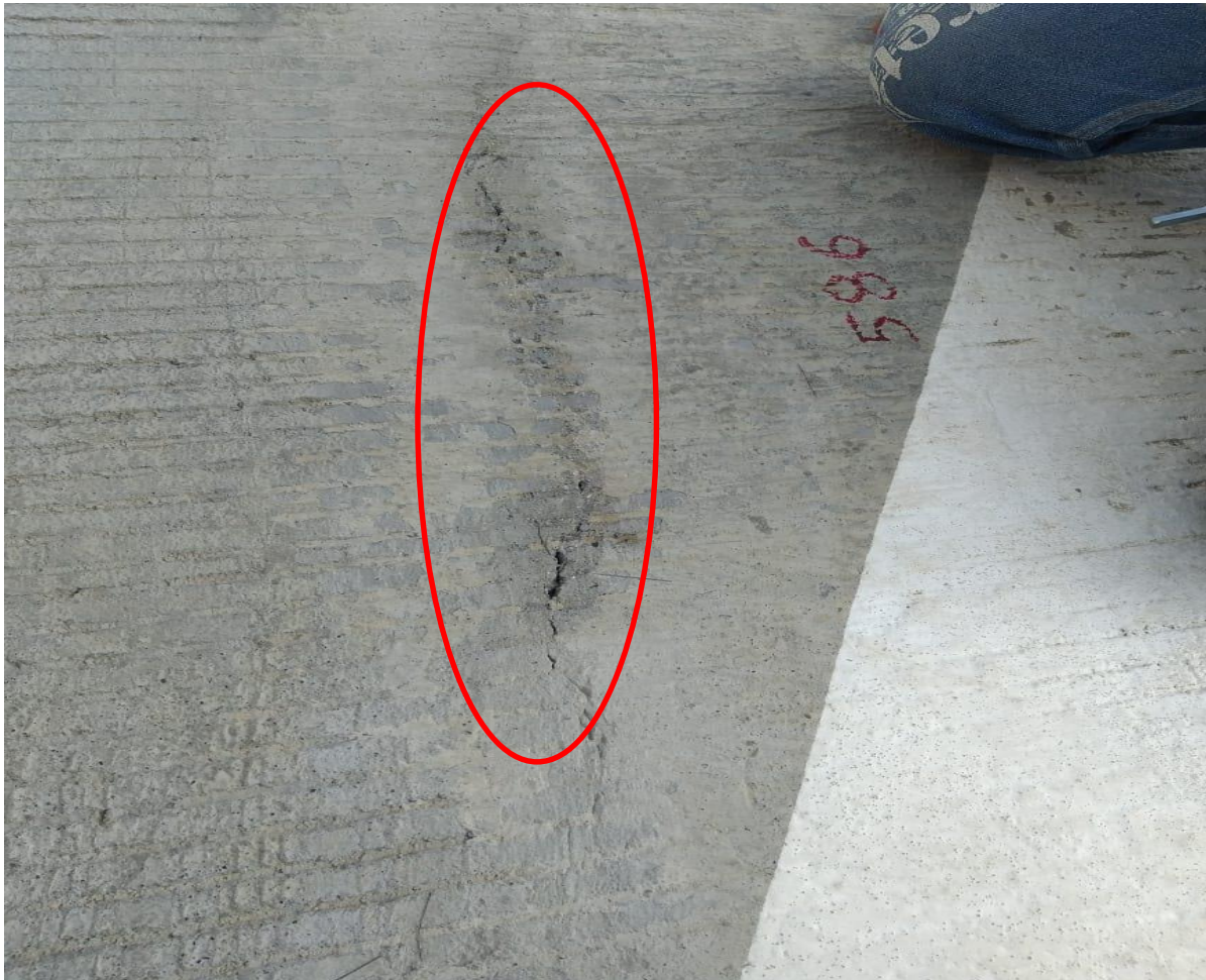
Figura 41. Fisura en pavicreteo MR 45
