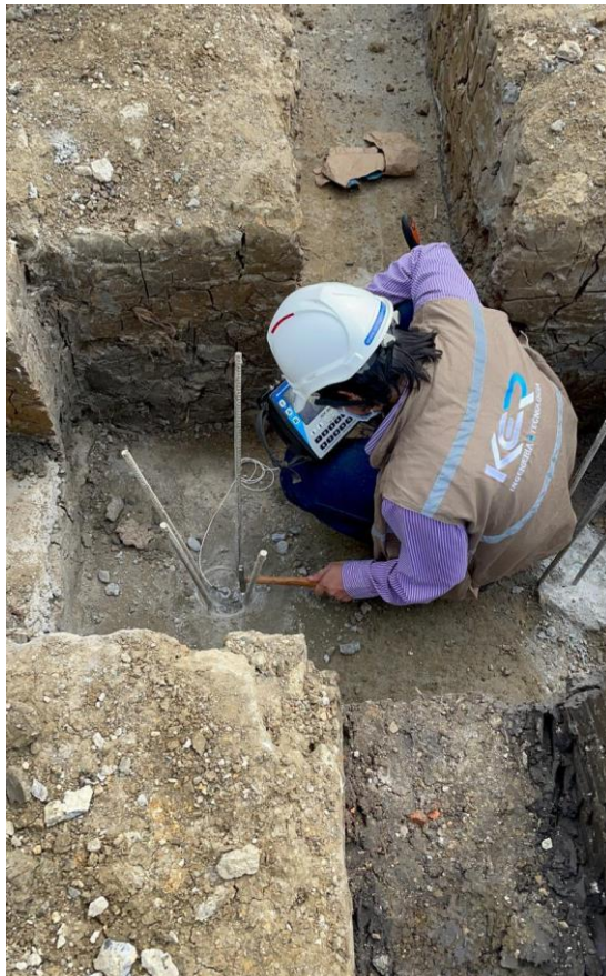
Figura 35. PIT con descabece.
