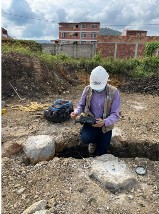
Figura 34. Prueba integridad pilote sin descabece.
