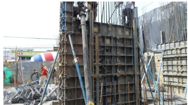
Ilustración 4: Vaciado y vibrado de concreto de 5000 psi en pantalla P6 nivel N+0.23 m. Fuente: Peralta Ingeniería S.A.S.
