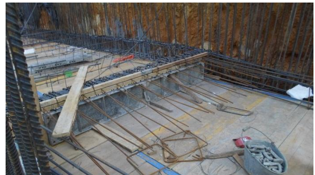
Ilustración 4: Pelos de la rampa vehicular sótano 1.2 nivel N-1.20 m. Fuente: Peralta Ingeniería S.A.S.
