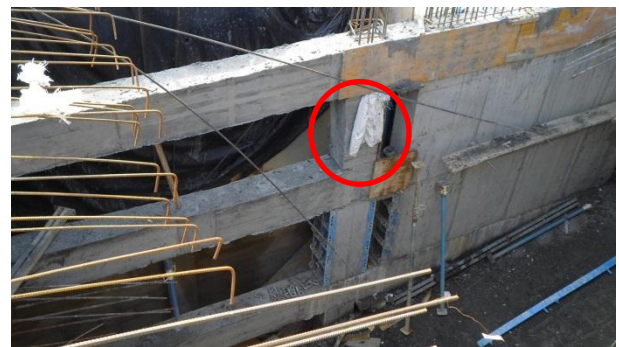
Ilustración 4: Columna C-A.23' nivel N+3.48 m torcida. Fuente: Peralta Ingeniería S.A.S.
