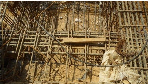
Ilustración 3: Detalle estado de suciedad en el acero de refuerzo. Fuente: Peralta Ingeniería S.A.S.
