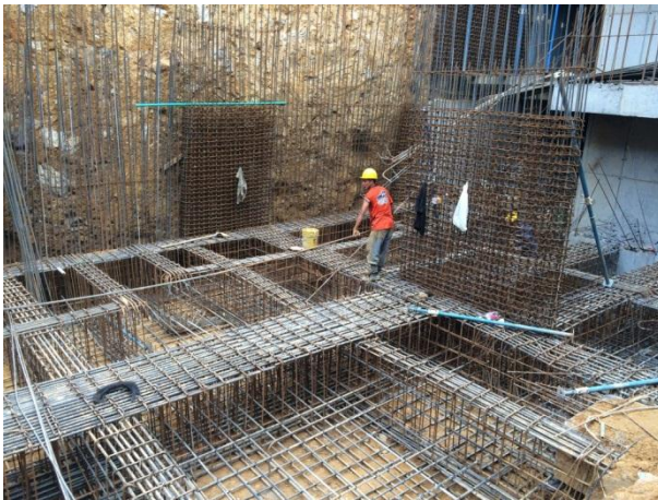
Ilustración 3: Armado de vigas en el nororiente de la cimentación nivel N-6.90 m. Fuente: Peralta Ingeniería S.A.S.
