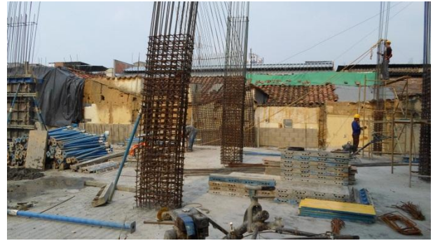
Ilustración 3: Columnas C-B1.41 y C-B4.41 armadas correctamente nivel N+1.84 m. Fuente: Peralta Ingeniería S.A.S.
