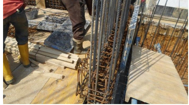
Ilustración 8: Viga VP11-24a armada de manera incorrecta. Fuente: Peralta Ingeniería S.A.S.
