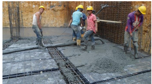
Ilustración 4: Fundida de vigas y placa entrepiso del sótano 2 N-4.05m. Fuente: Peralta Ingeniería S.A.S.
