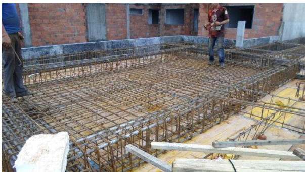
Ilustración 4: Armado de placa maciza e = 0.20 m para fondo de piscina nivel N+10.33 m. Fuente: Peralta Ingeniería S.A.S.
