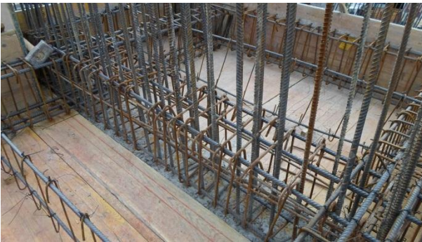
Ilustración 1: Viga VP31-24a a la que le faltaban 3 estribos nivel N+7.73m. Fuente: Peralta Ingeniería S.A.S.
