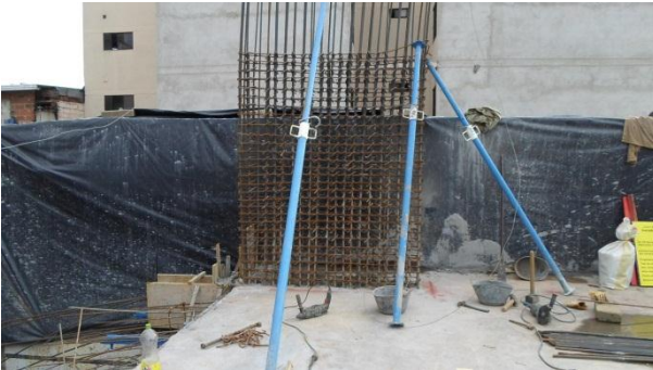
Ilustración 6: Pantalla P8 nivel N+3.48 a la que le faltaba la viga VP21-5. Fuente: Peralta Ingeniería S.A.S.
