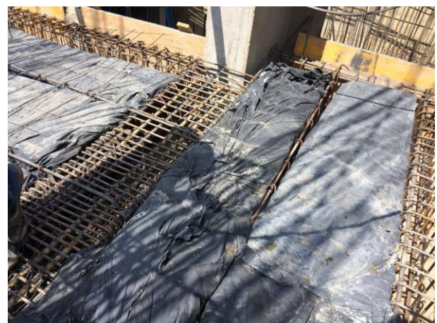
Ilustración 5: Casetones elaborados con dimensiones equivocadas. Fuente: Peralta Ingeniería S.A.S.
