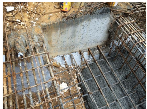
Ilustración 6: Aplicación puente de adherencia concreto fresco a endurecido. Fuente: Peralta Ingeniería S.A.S.
