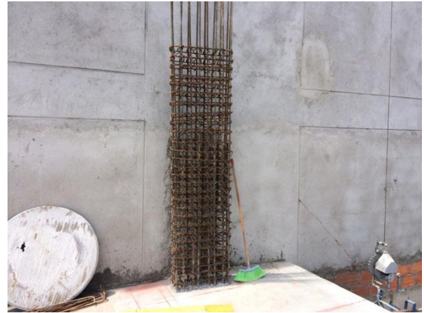
Ilustración 2: Columna C-D.5 nivel N+4.88 m armada de manera incorrecta. Fuente: Peralta Ingeniería S.A.S.
