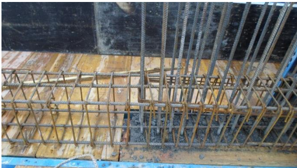
Ilustración 2: Viga VP40-A piso 4 nivel N+10.58 m armada de manera incorrecta. Fuente: Peralta Ingeniería S.A.S.
