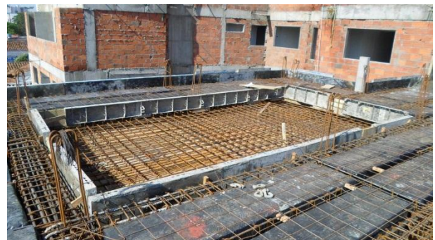
Ilustración 5: “Pelos” para mampostería confinada de zona de acceso a piscina y muros de piscina. Fuente: Peralta Ingeniería S.A.S.
