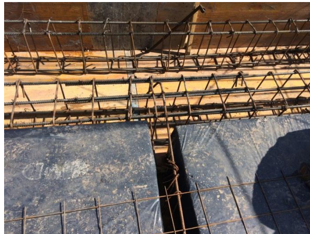
Ilustración 1: Riostra incompleta. Fuente: Peralta Ingeniería S.A.S.
