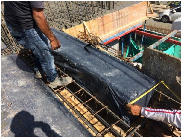
Ilustración 2: Casetón elaborado con dimensiones equivocadas. Fuente: Peralta Ingeniería S.A.S.
