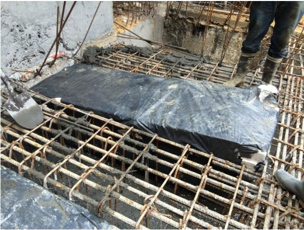
Ilustración 9: Casetón elaborado con dimensiones inadecuadas. Fuente: Peralta Ingeniería S.A.S.
