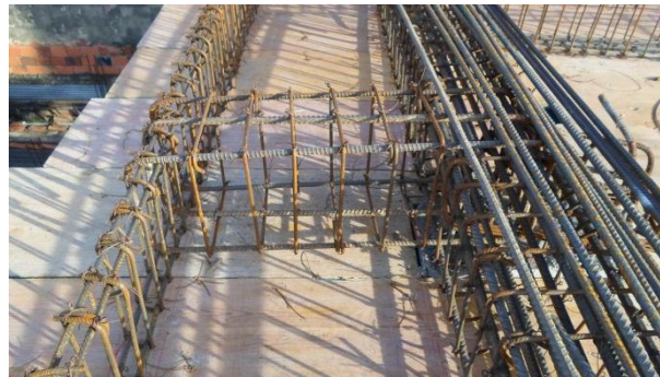
Ilustración 1: Viga VP40-5b nivel N+10.58 m armada de manera correcta. Fuente: Peralta Ingeniería S.A.S.
