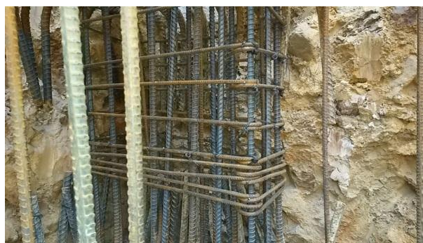
Ilustración 3: Refuerzo transversal de la columna C-B2.5 armado de manera errónea. Fuente Peralta Ingeniería S.A.S
