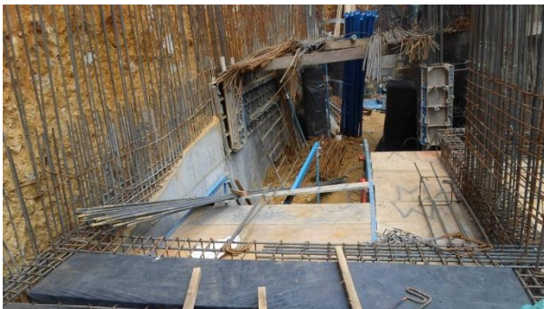
Ilustración 3: Tramo de la viga VS2-31 que recibe la rampa no confinado en su totalidad. Fuente: Peralta Ingeniería S.A.S.
