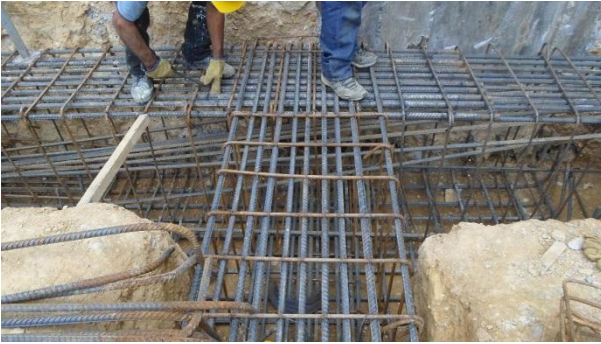
Ilustración 1: Corrección del traslapo en la viga V00-5. Fuente: Peralta Ingeniería S.A.S.
