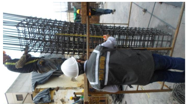
Ilustración 4: Revisión de armado columna C-B1.41 nivel N-1.20 m. Fuente: Peralta Ingeniería S.A.S.
