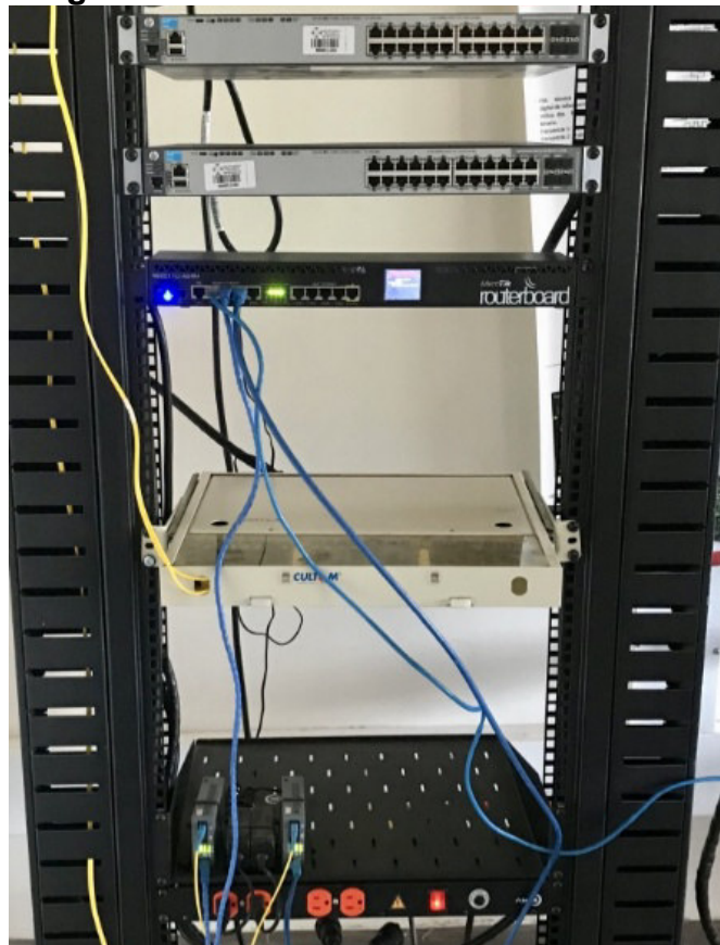
Figura 8.8 Router salón comunicaciones
