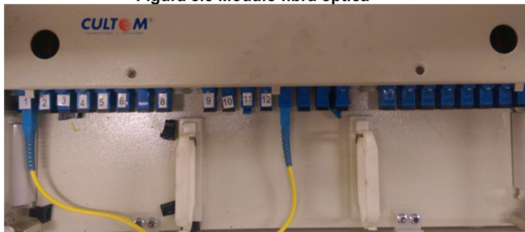
Figura 8.5 Modulo fibra óptica
