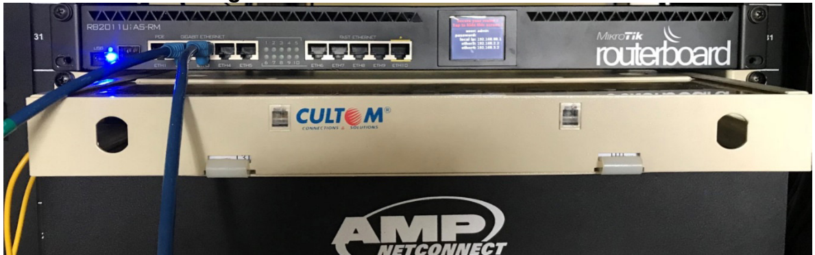
Figura 8.65 Desconexión física ether 4
