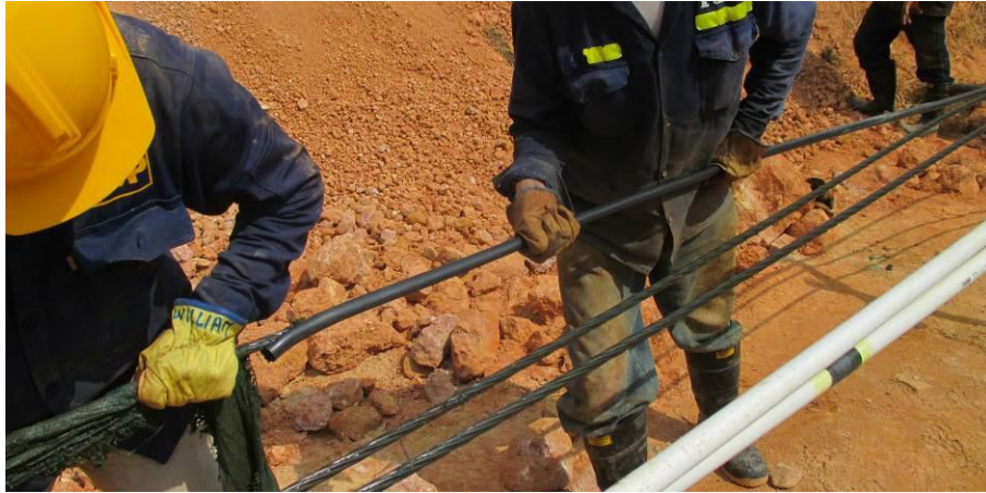
Figura 30. Instalación de manguera de polietileno en la zona libre de los anclajes
