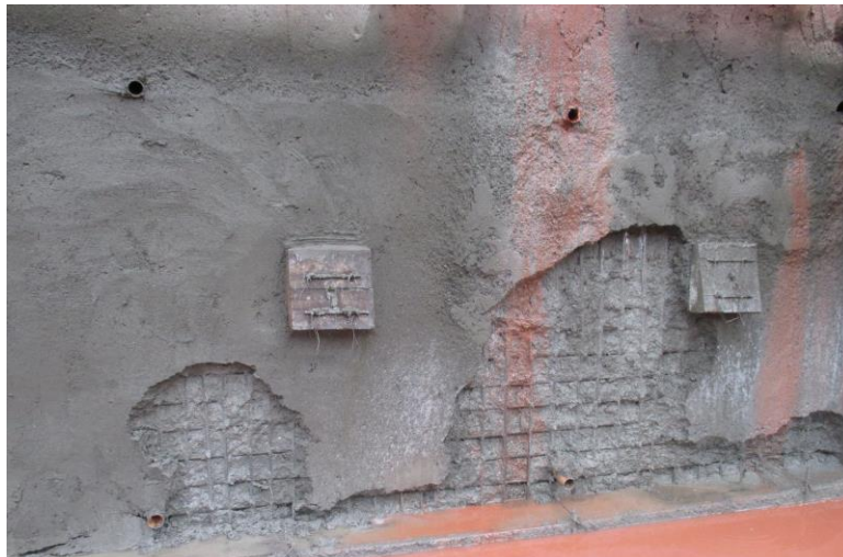
Figura 20. Escurrimiento del concreto lanzado
