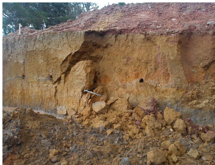
Figura 16. Deslizamiento ocurrido por realizar excavaciones completas
