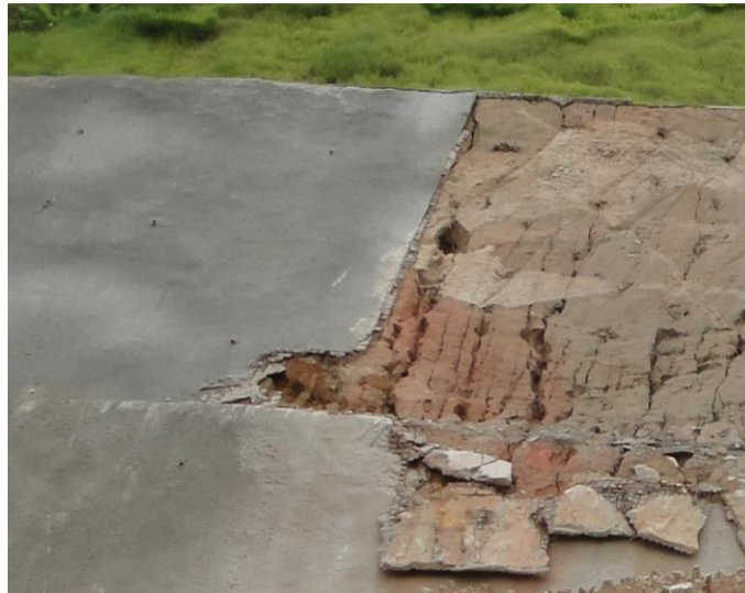
Figura 22. Desprendimiento de pantalla por falla en el gancho de los pernos
