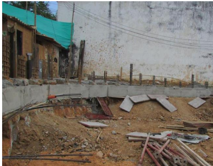
Figura 24. Erosión en áreas entre micropilotes
