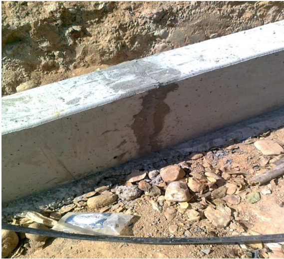
Figura 26. Sardinell con grietas
