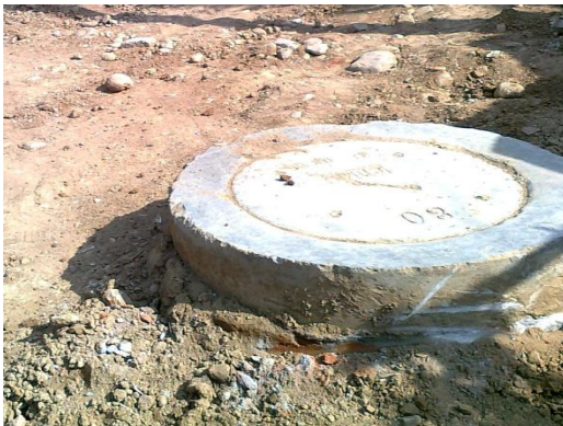
Figura 58. Pozo sin nivelar
