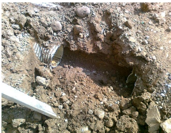
Figura 10. Tubería rota aguas negras
