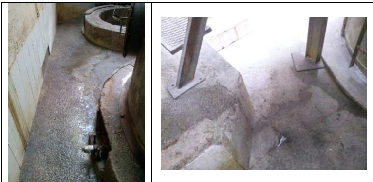
Figura 5. Al limpiar el reguero de sebo con agua de condensados.
