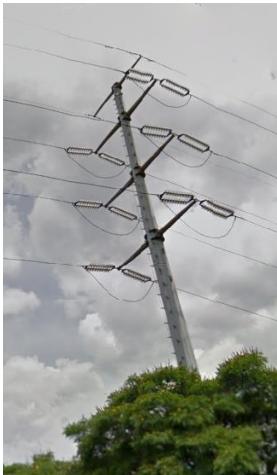
Estructura compacta tipo poste
