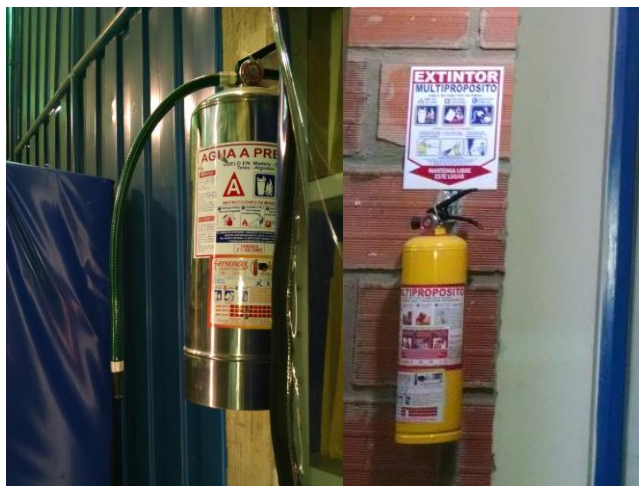
Figura 5. Extintores en el primer y segundo piso, respectivamente.
