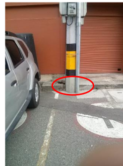
Figura 27. Bloque 11, ubicación del poste de la subestación
