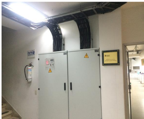
Figura 53. Tablero zonas comunes contiguo a la morgue
