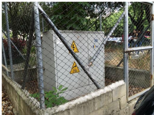
Figura 19. Bloque 8, transformador 300 kVA
