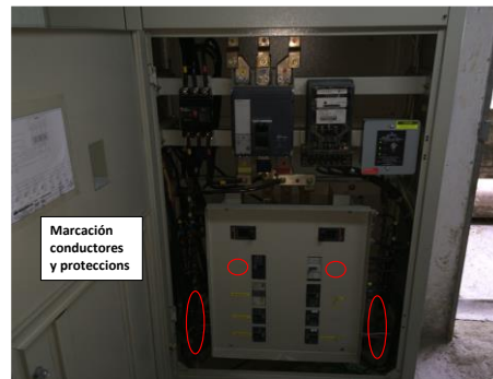
Figura 15. Bloque, tablero distribución CPA
