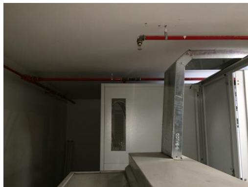
Figura 31. Bloque 9, sistema contra incendio
