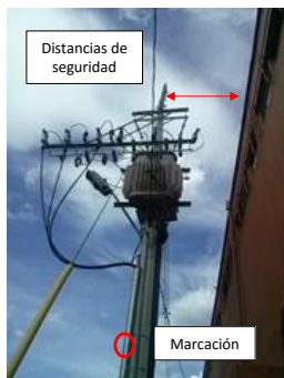
Figura 26. Bloque 11, falencias técnicas en subestación
