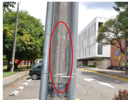
Figura 56. Grietas en poste aisladero, glorieta virtual bloque 11
