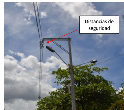
Figura 54. Poste de suspensión, al frente bloque 11
