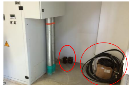
Figura 33. Bloque 9, almacenamiento de materiales no permitidos en una subestación
