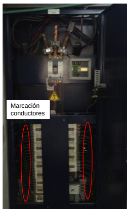
Figura 14. Bloque 8, tablero laboratorio mecánica
