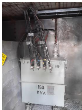
Figura 11. Bloque 8, transformador 150 kVA
