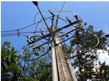
Figura 58. Poste aisladero, bloque administrativo
