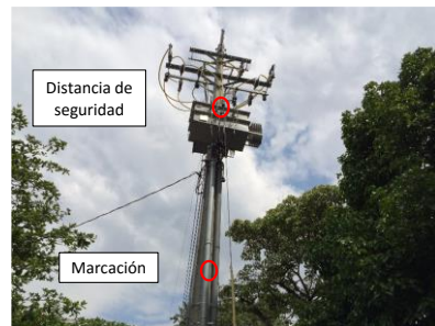
Figura 36. Bloque 10, no conformidades en subestación tipo poste
