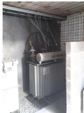
Figura 12. Bloque 8, transformador 110 kVA
