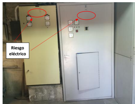
Figura 46. Bloque Garajes, avisos de riesgo eléctrico
