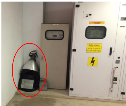
Figura 34. Bloque 9, almacenamiento de materiales ajenos a la subestación
