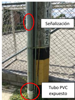
Figura 61. Poste aisladero, cancha de cemento bloque 6, falencia técnicas
