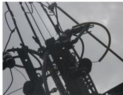
Figura 57. Incorrecta instalación DPS, Poste aisladero glorieta virtual bloque 11.
