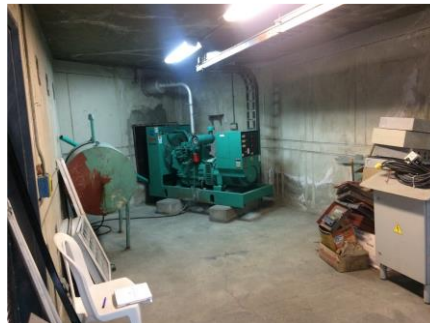
Figura 45. Bloque Garajes, almacenamiento de materiales no permitidos en una subestación
