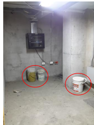
Figura 18. Bloque 8, cuarto aires acondicionados, elementos ajenos a la instalación eléctrica
