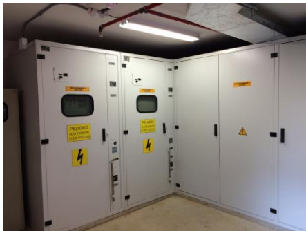
Figura 30. Bloque 9, correcta marcación tableros eléctricos
