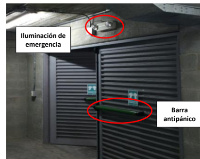
Figura 25. Bloque parqueaderos, iluminación de emergencia y barra anti pánico
