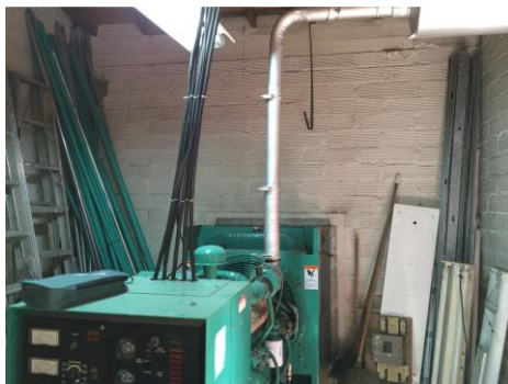
Figura 6. Bloque 12, almacenamiento de materiales no permitidos en una subestación
