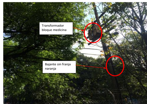
Figura 52. Subestación tipo poste bloque medicina
