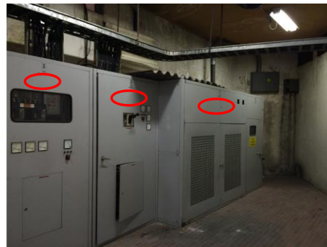
Figura 2. Bloque administrativo, marcación aviso riesgo eléctrico
