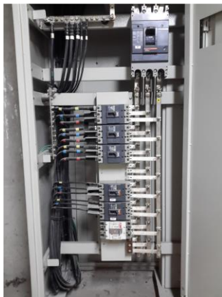
Figura 17. Bloque 8, tablero de distribución aires acondicionados
