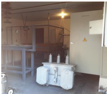
Figura 29. Bloque 11, almacenamiento de elementos no permitidos en una subestación
