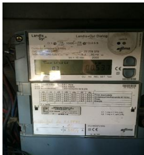
Figura 63. Medidor eléctrico de la frontera comercial
