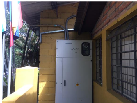
Figura 48. Tablero alimentado desde el transformador de 75 KVA
