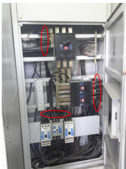
Figura 41. Bloque Bachillerato, ML principal, marcación conductores
