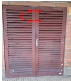
Figura 43. Bloque Bachillerato, puerta de acceso subestación principal
