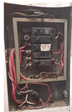
Figura 38. Bloque 10, tablero eléctrico del cuarto eléctrico baño damas
