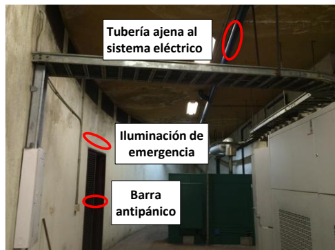
Figura 3. Bloque administrativo, falencias técnicas
