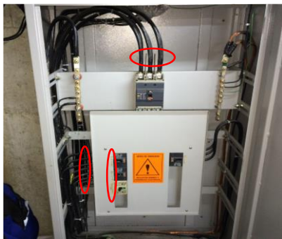
Figura 9. Bloque 7 ascensores, marcación conductores y breakers
