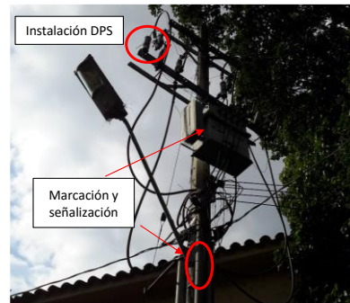
Figura 4. Bloque 12, falencias técnicas en subestación
