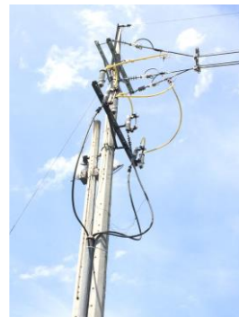
Figura 62. Poste derivación, cancha de tenis
