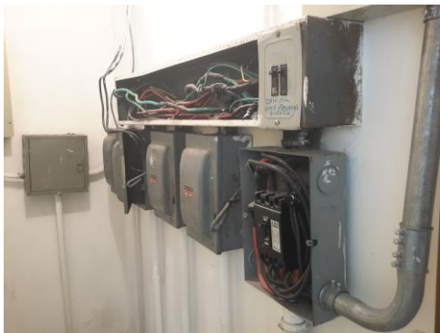
Figura 37. Bloque 10, protecciones eléctricas del cuarto eléctrico baño damas
