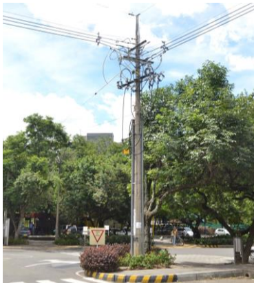
Figura 55. Poste aisladero, glorieta virtual bloque 11
