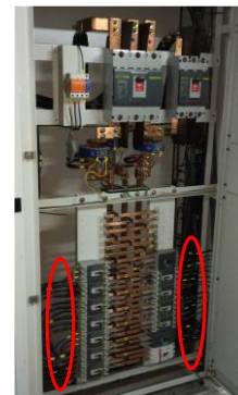
Figura 24. Bloque Parqueaderos, gabinete principal, correcta marcación conductores
