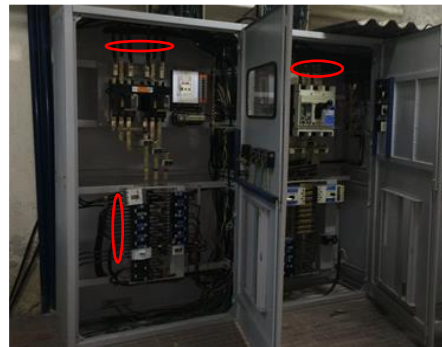
Figura 1. Bloque administrativo, marcación conductores
