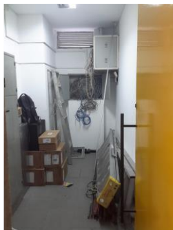
Figura 40. Bloque 10, almacenamiento de materiales ajenos a la subestación
