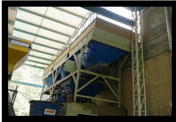
Figura 14: Tolva de pesaje.
