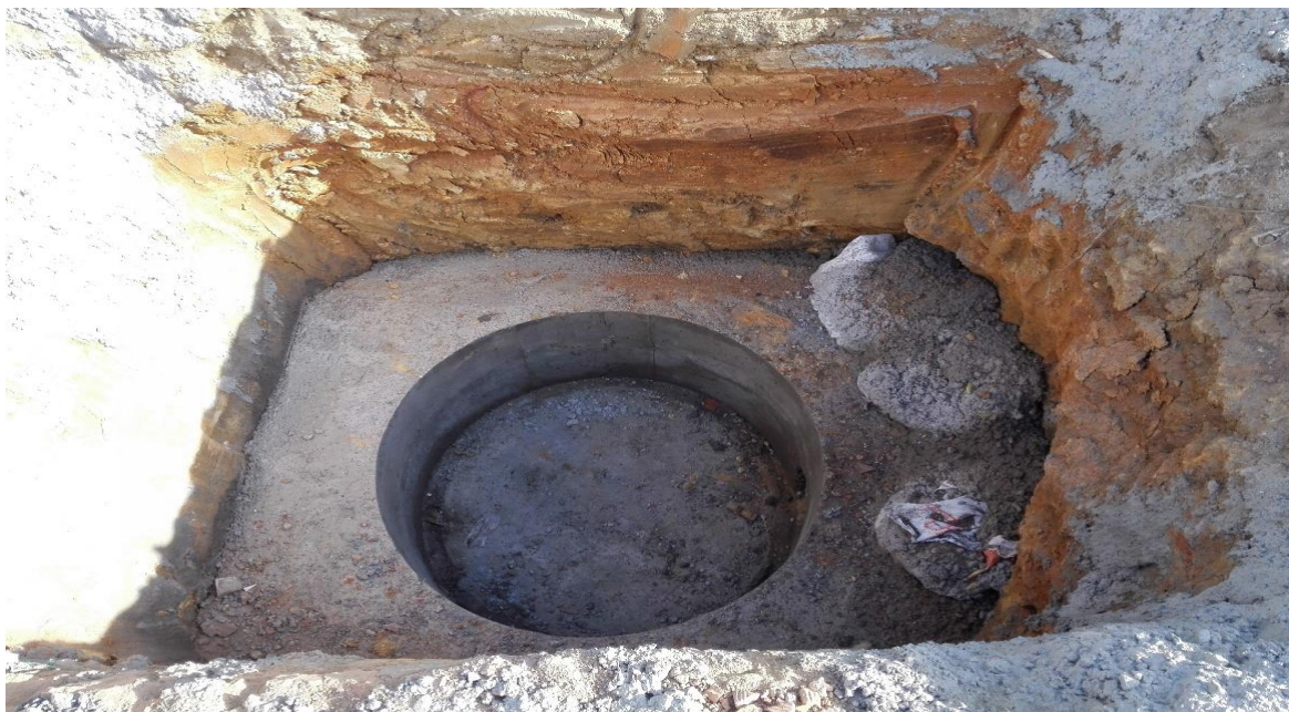
FIGURA 12 POZO AGUAS NEGRAS P(URBP)R6
