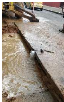
Ilustración 179. Daño en tubería realizado por la excavación
