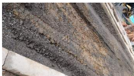
Ilustración 49. Retiro de material de la sub-base granular por enlodamiento de subrasante
