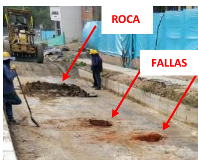
Ilustración 17. Fallas encontradas en la subrasante, calzada norte
