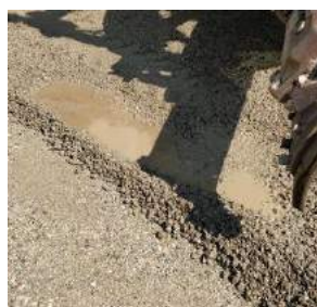
Ilustración 46. Charco generado por fuertes lluvias en la sub-base granular
