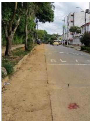
Ilustración 154. Zanja en carrera 23 abscisa 180
