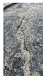
Ilustración 36. Socavación de imprimación por fuertes lluvias
