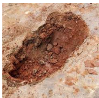
Ilustración 18. Detalle de falla de subrasante calzada norte
