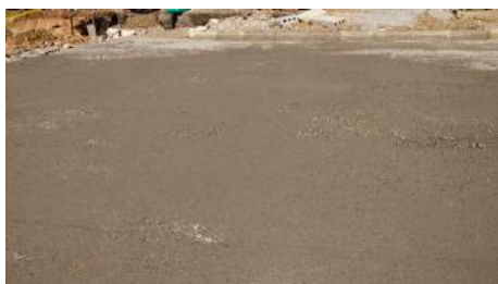
Ilustración 48. Exceso de humedad en la base granular después de fuertes lluvias
