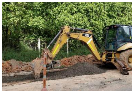
Ilustración 165. Fallo con mejoramiento y base granular
