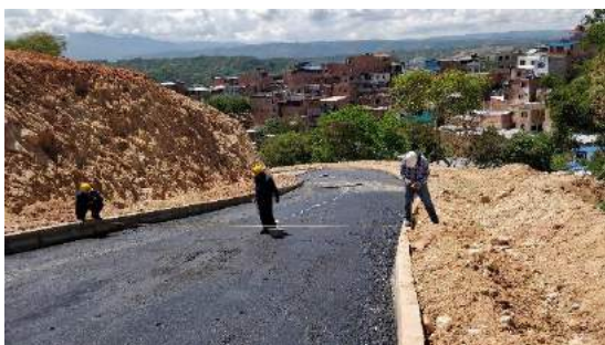
Ilustración 93. Ayudante junto con el inspector miden y marcan con cal diluida en agua la mitad de la calzada
