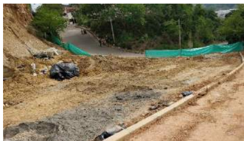
Ilustración 70. Vía antes de ser intervenida (tramo inferior)
