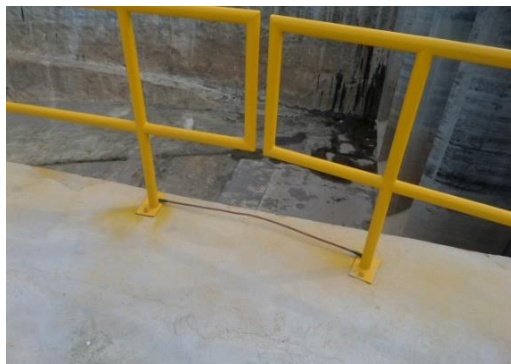
Ilustración 5 Puesta a Tierra Estructuras Metálicas
