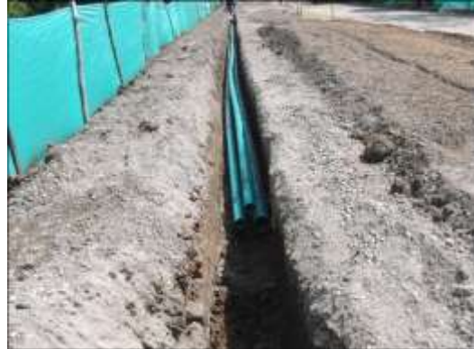
Instalación de banco ductos de 4" y 6" PVC DB para red de Media Tensión
