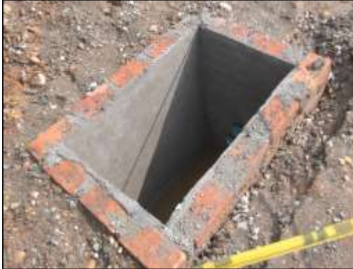
Cajas en mampostería para red de Telecomunicaciones
