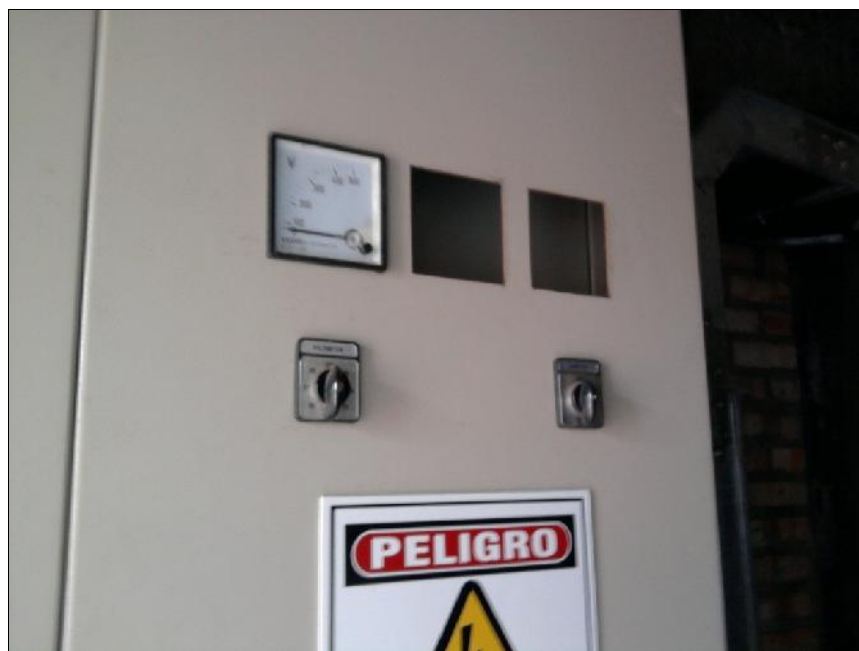
Foto 10. Tablero de generador sin elementos de medida.
