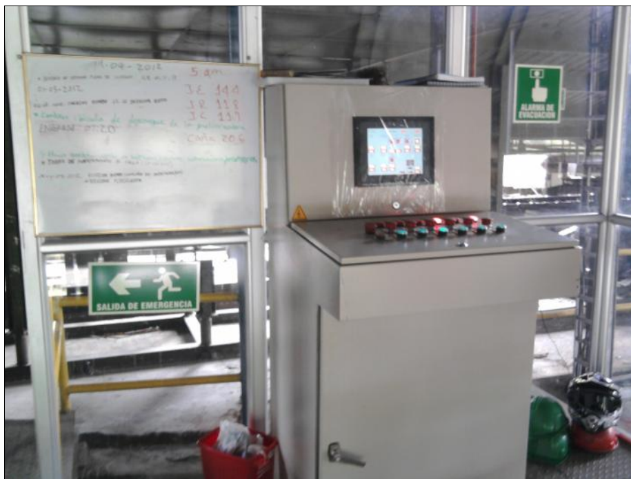
Foto 7. Vista Cuarto de Control HMI (Planta de Elaboración)
