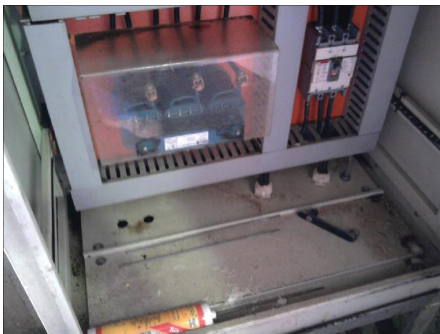
Foto 14. Piezas sueltas y elementos que no corresponden en el tablero.
