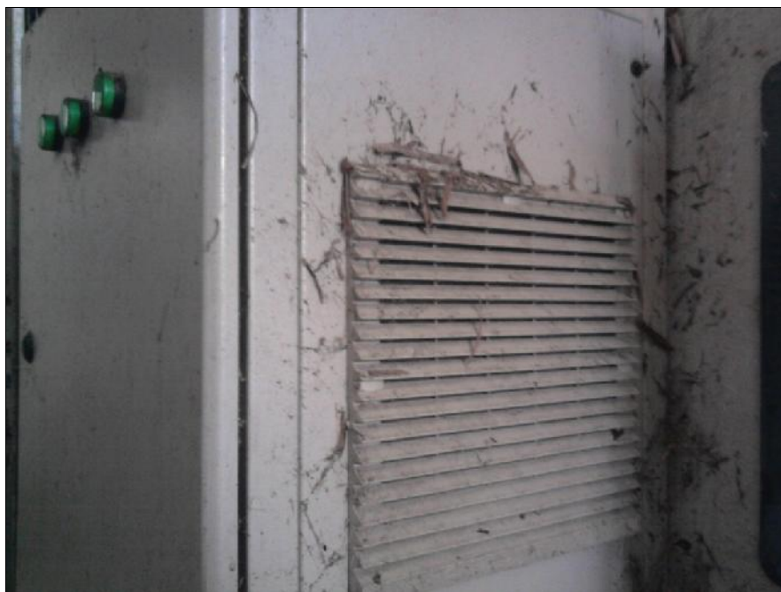
Foto 9. Tablero de potencia sin mantenimiento.
