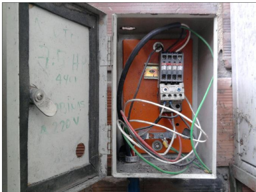
Foto 11. Caja eléctrica desordenada.
