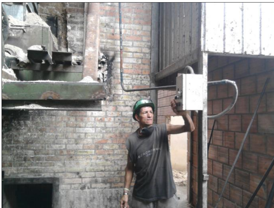
Foto 24. Vista Operario de Mandos Alimentación de Caldera (P.E)
