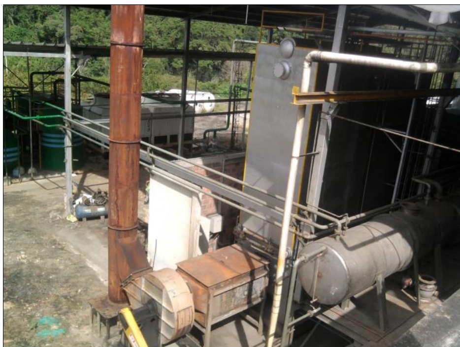
Foto 4. Vista Zona Nort-Este Caldera (P.E)
