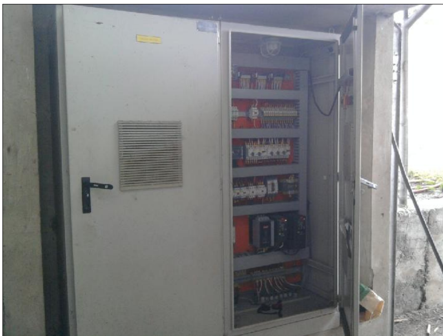
Foto 16. Tableros de control abiertos constantemente.
