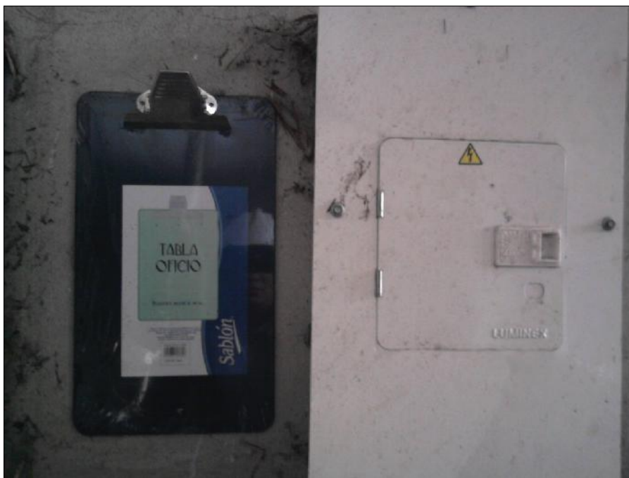
Foto 13. Tablilla para registro de control sin uso adecuado.
