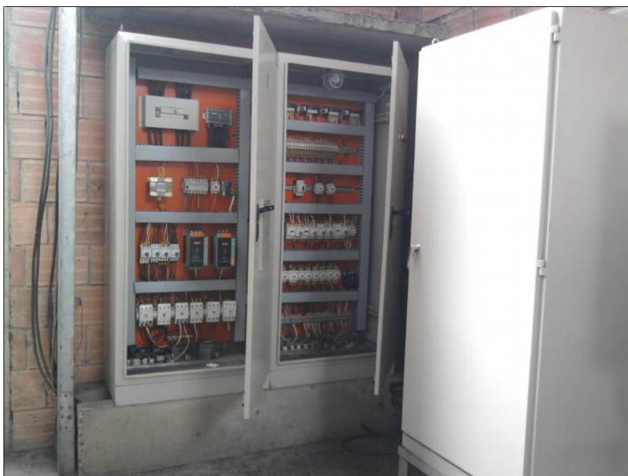
Foto 8. Vista Tablero de Vapor (Planta de Elaboración)
