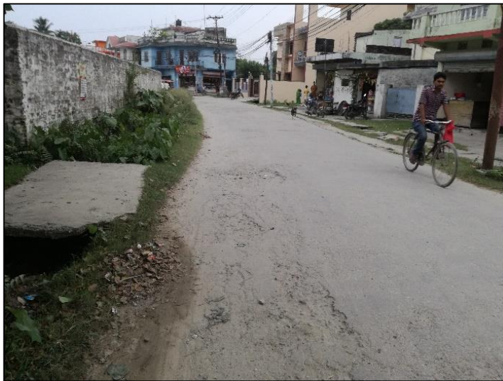
Figura 23. Condiciones del Pavimento
