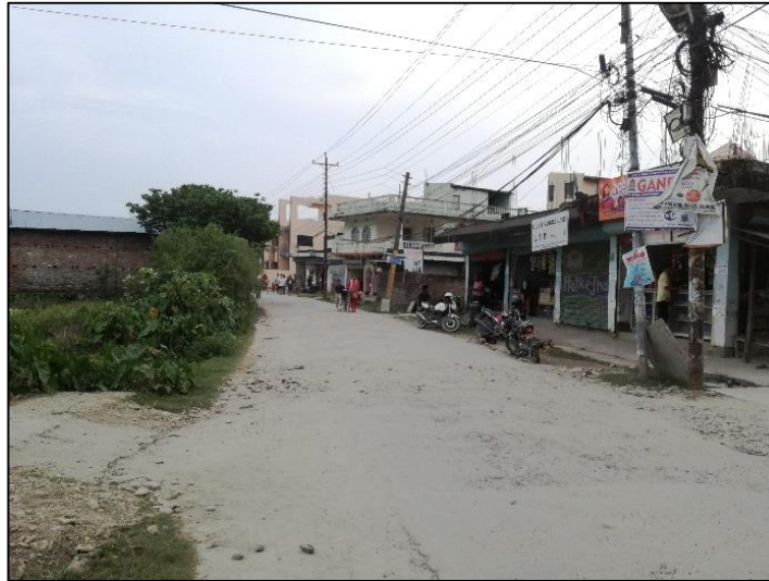
Figura 24. Condiciones del Pavimento
