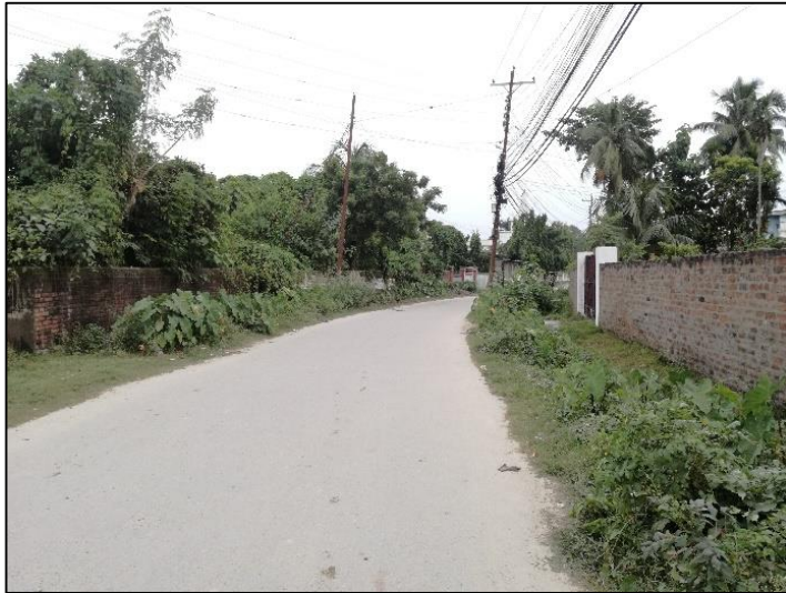
Figura 22. Condiciones del Pavimento
