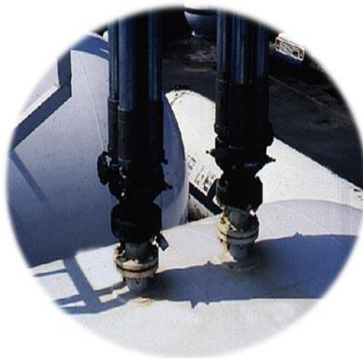
Imagen 3. Sistema de seguridad tanque cerrado. [4]
