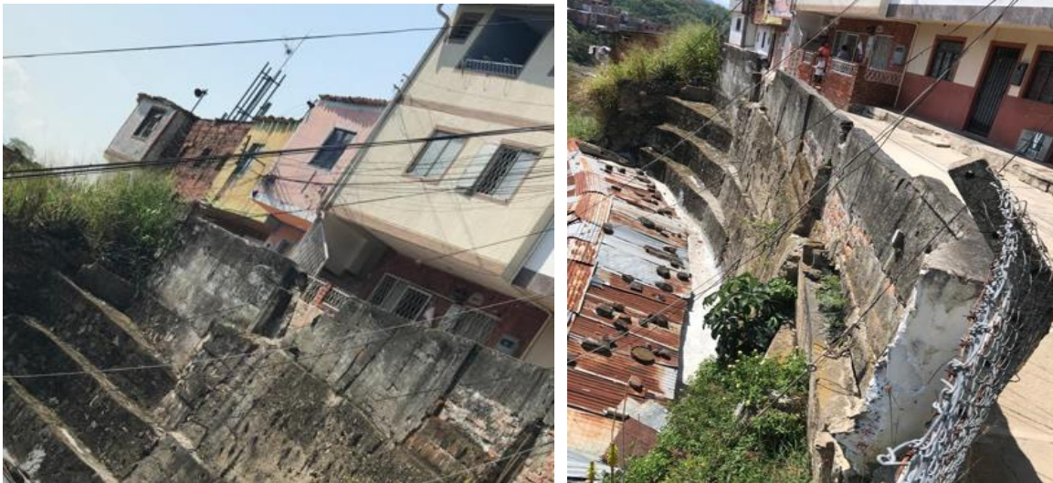
Ilustración 5. Frontal Muro en deterioro
