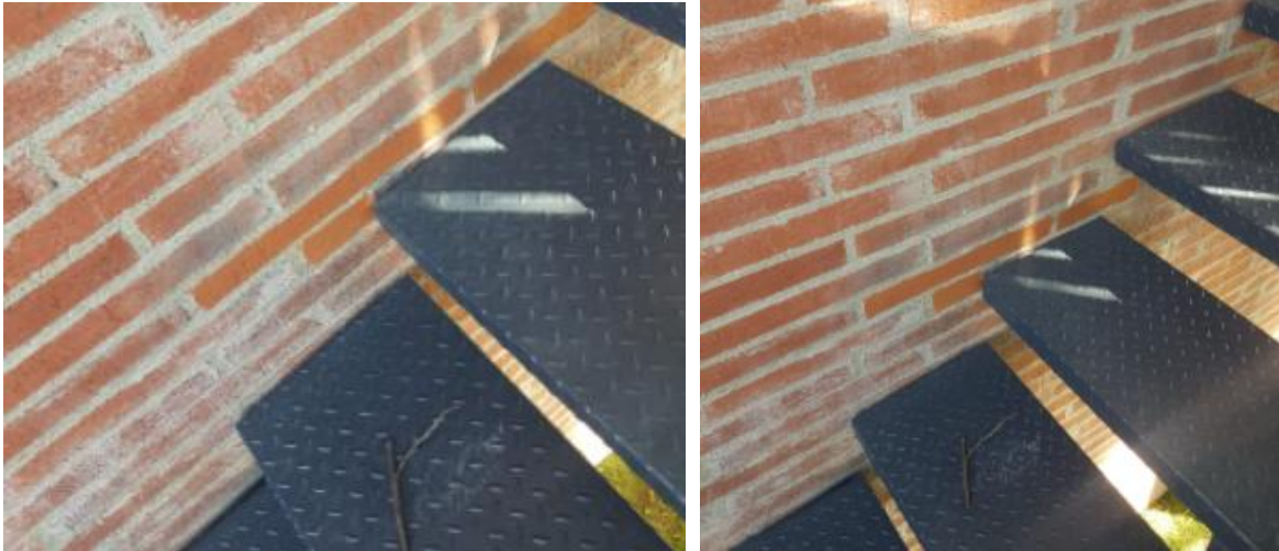
Ilustración 29. Manchas Muro lateral Escaleras.
