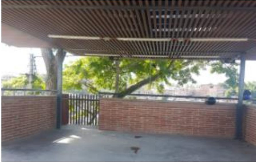
Ilustración 41. Implementación Baranda Adicional.
