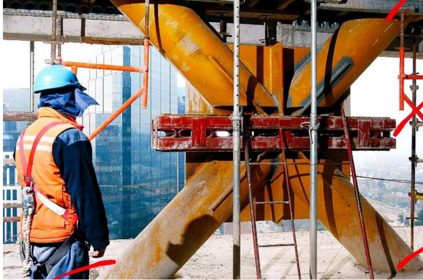
Fig. 14 Disipador de energía, edificio Titanium en Santiago de Chile (Vargas Bello)
