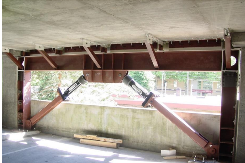
Fig. 8 Disipadores viscosos instalados (CDV Ingeniería Antisísmica)
