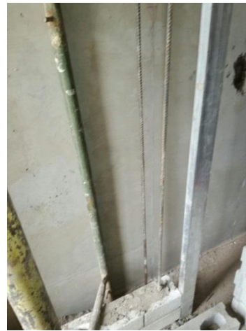
Figura 65. Dovela de buitrón en balcón.
