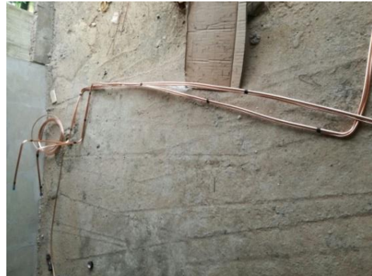
Figura 69. Tubería de 1/2" y de 1/4" armada y unida con cinta aislante.
