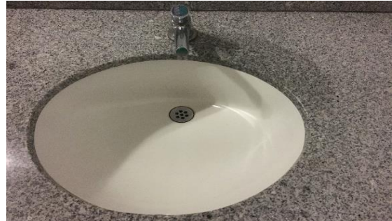
Figura 36: Lavamanos tipo, edificio k.
