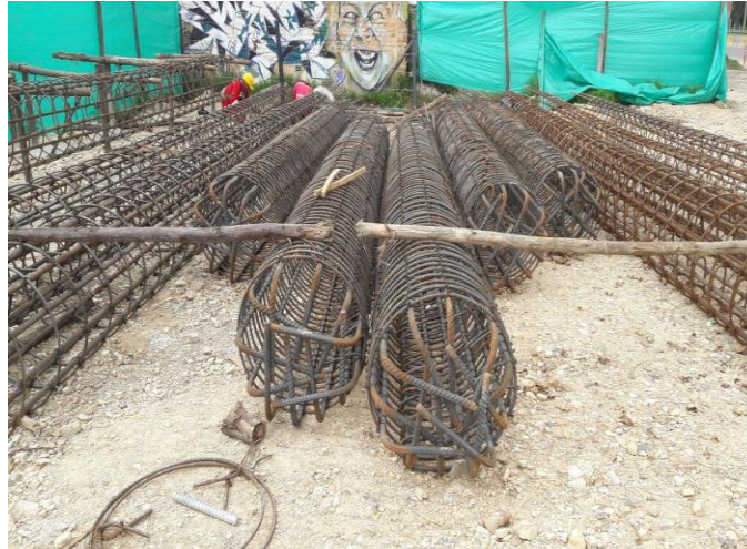
Figura 19: Armadura de pilote mal fabricada. (Autor)
