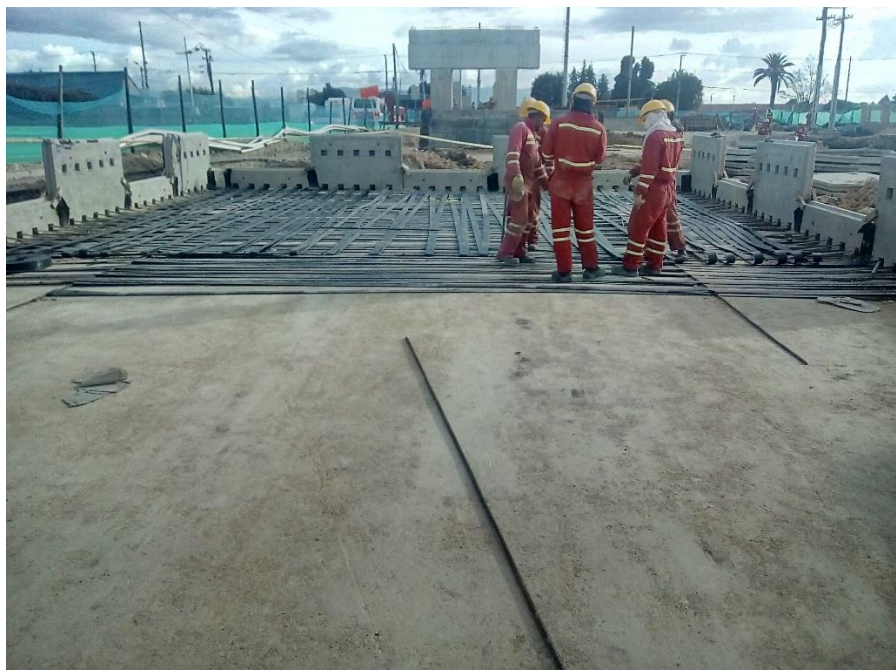
Figura 15: Correas puestas en sitio, muro de tierra armada sobre el eje 1. (Autor)
