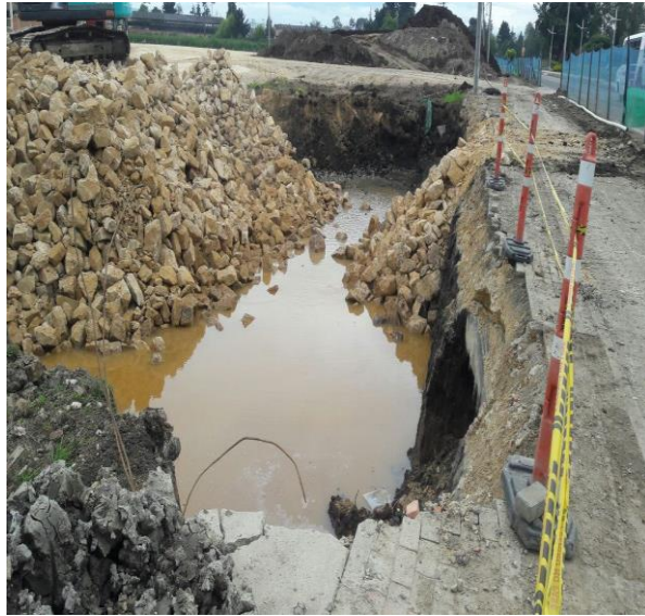
Figura 12: Nivel freático muro en tierra armada sobre el eje 1. (Autor)
