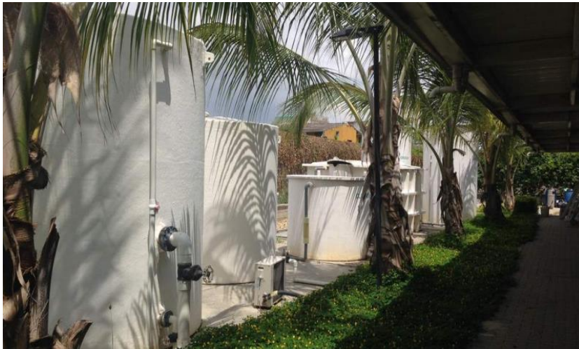
Figura 16: Planta de Tratamiento de Aguas Residuales.
