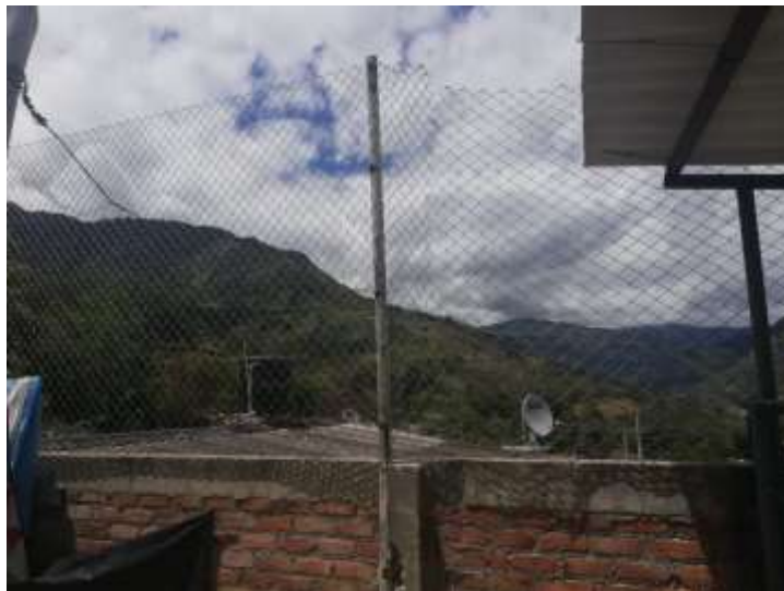
imagen 10: Cerramiento en malla eslabonada Cal 10 mm.
