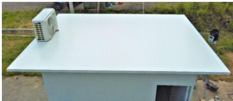
Figura 32: Recinto (container) – Vista superior
