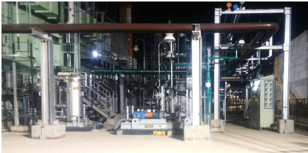
Figura 9. Subsistemas del Turbo Generador
