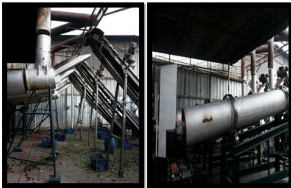
Falta de mantenimiento, preventivo, proactivo, basado en confiabilidad falta de TPM. FUENTE: Propia, Autor July Uribe C. Departamento de producción.
