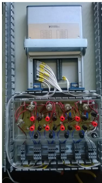
Figura 39. Panel de control y adquisición, Cableado
