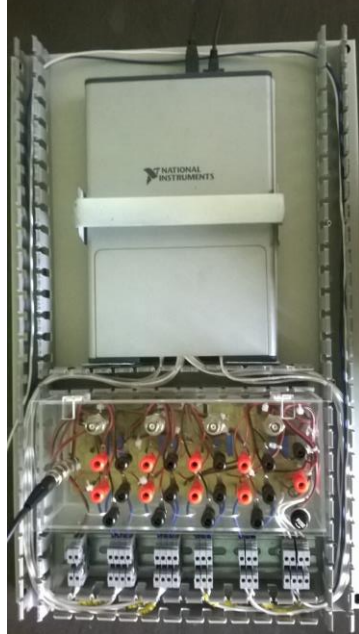
Figura 38. Panel de control y adquisición implementado.
