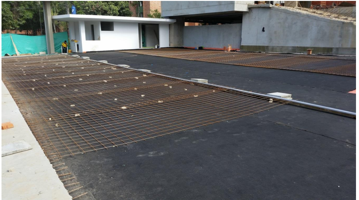
Figura 7. Armado de malla y formaleta para fundida de placa de concreto sobre el sistema de impermeabilización. Fuente propia
