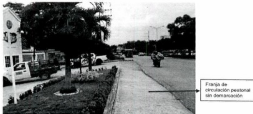
Fotografía No. 6: Franja de circulación peatonal no se encuentra visiblemente demarcada, tampoco se evidencia franja de textura diferente a la superficie de la vía que oriente el desplazamiento de personas con discapacidad visual
