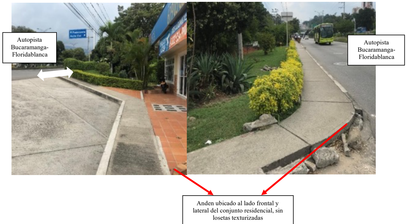
Fotografía No. 3 y 4: Andenes aledaños al acceso vehicular al conjunto residencial, no se aprecia instalación de loseta texturizada guía ni loseta texturizada guía de alerta. Ni franja demarcadora visual
